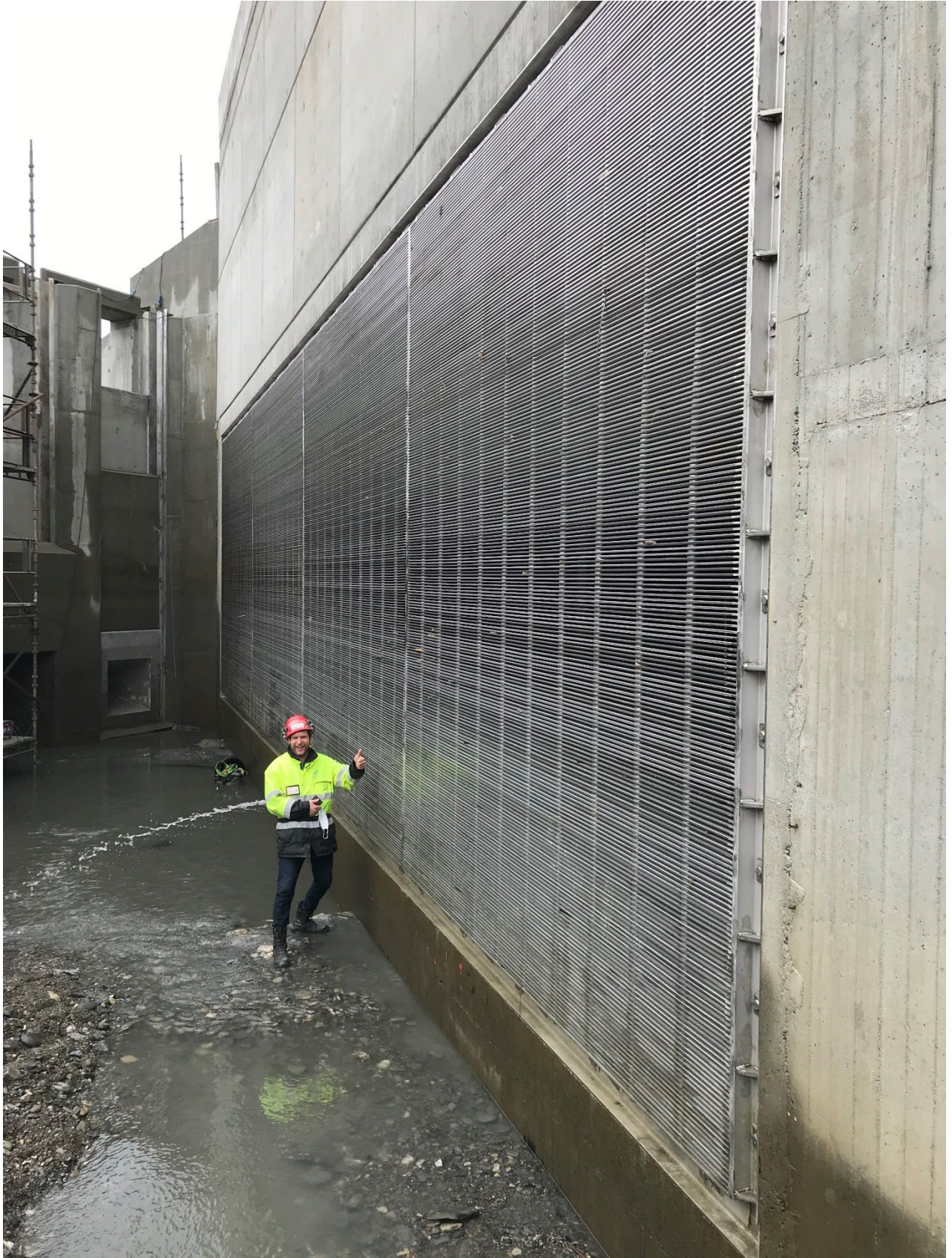
Vannkraftverk Palmafossen i Raundalselva (Voss) med beta-varegrind foran inntak, fluktåpning med bunn- og overflateinntak.
