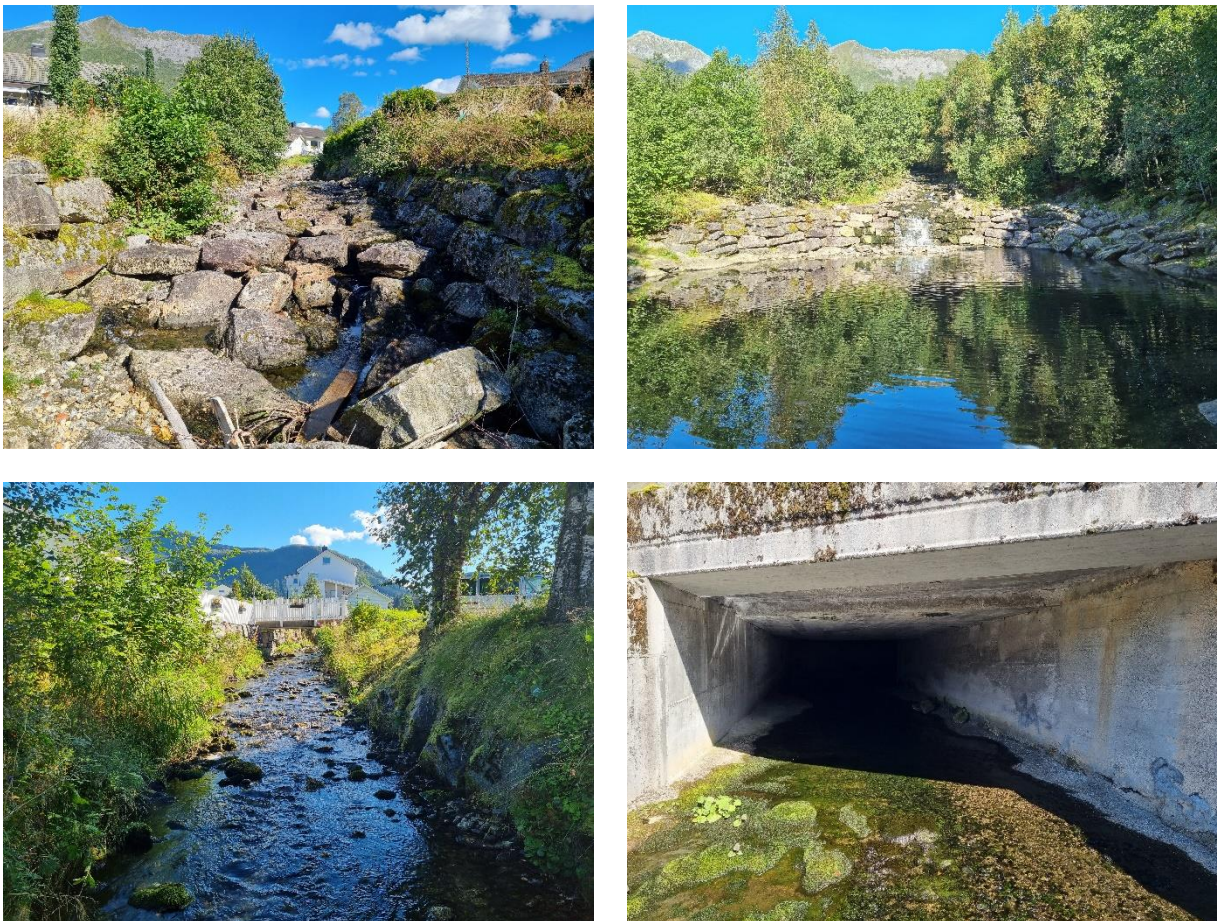
Figur 24. Skytjeåa. Bunnplastring hvor vannet renner under blokkene og blir et kunstig temporært vandringshinder (oppe t.v.), kunstig permanent vandringshinder (oppe t.h.), gyteområde med naturlig elvebunn og noe forbygninger (nede t.v.) og kulvert med betongbunn under vei (nede t.h.).
