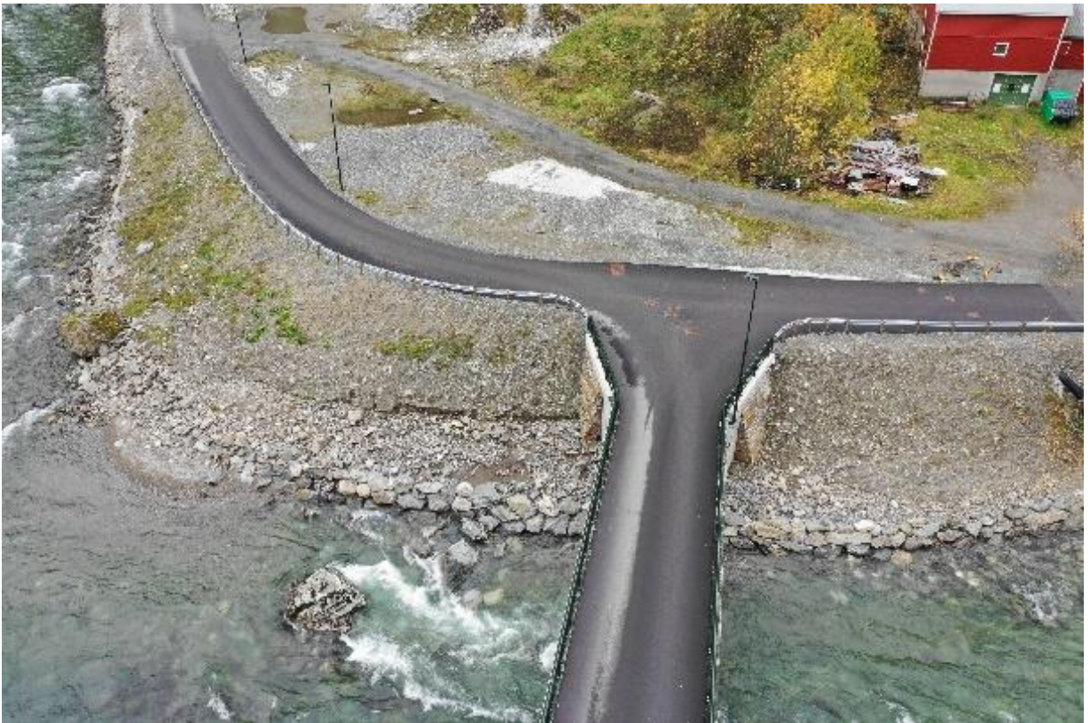
Figur 52. Begynnende erosjon bak forbygningen ndf Leinafoss kraftverk og ovenfor Brekke bru etter høstflommen 2018 ( 192 \text{ m}^3/\text{s} , ca. Q10-Q20).
