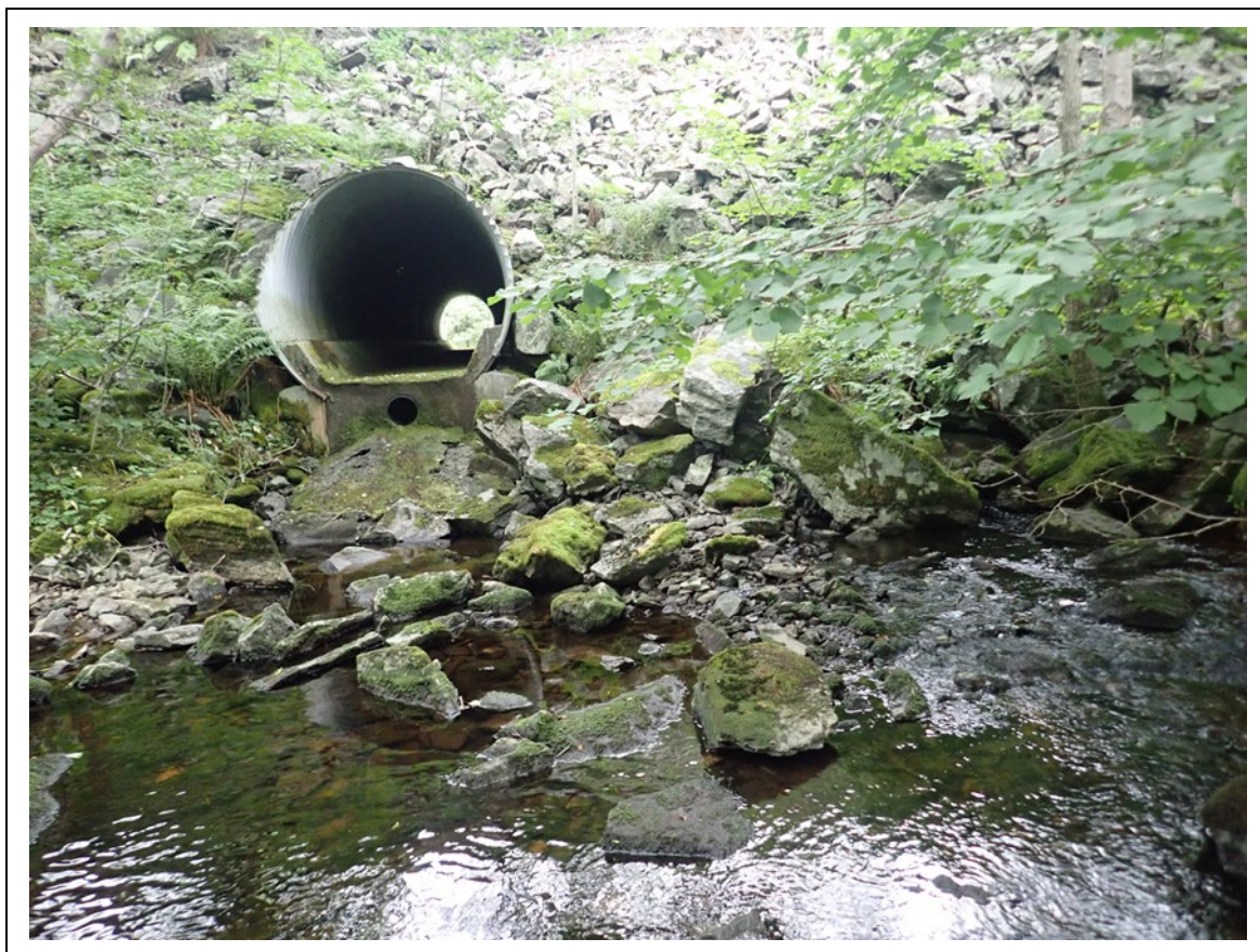
Kulvert under fylkesvei 5660 er vandringshinder.
