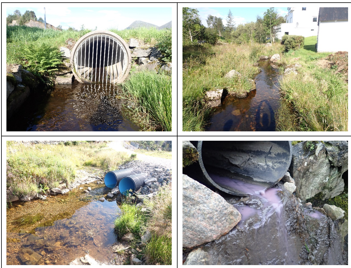
Venstre: Innløp til kulvert nederst i bekken fra Deknepollen. Høyre: Fint gyte- og oppveksthabitat lenger oppe i bekken. Venstre nede: Ved rørene øverst i bekken bør veigrus fjernes og erstattes av gytegrus (grusblanding av ulike størrelser), rullestein og trær. Høyre nede: Utslipp i nedre del av bekken 8. desember 2020.
