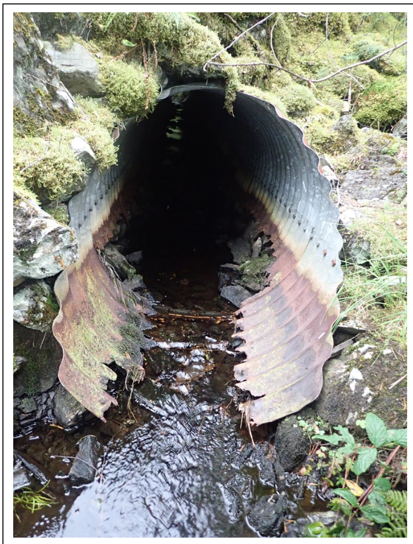
Elv sør for Slåttene krysser fylkesvei 5697 gjennom et rør. Dette røret var rustet i stykker og bekken har naturlig bunn gjennom hele dette krysningpunktet i dag.
