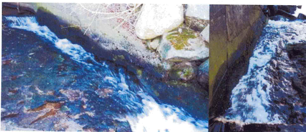
Figur 14. Kulvert i forbindelse med krysning av FV 44, med murt betongbunn, lav vanddybde og høy vannhastighet, er ikke tilfredsstillende etter vannforskriften. Kulverten er omtalt nærmere i Bækken & Bergan (2012, i arbeid). (Foto: M.A. Bergan 2011)
