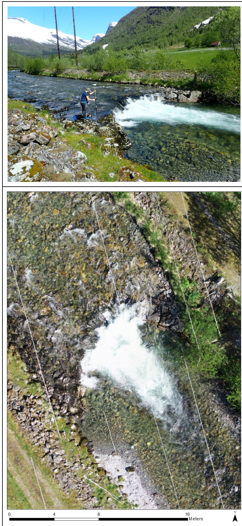
Figur 15. Terskel 16 bør få en dypere lavvannsrenne i midten og det bør legges ut flere blokkgrupper nedstrøms terskelen for å dempe vannhastigheten.
