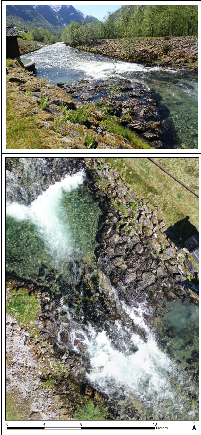
Figur 24. Unummerert terskel som ligger rett oppstrøms utløp Mel kraftstasjon. Det er viktig å etablere en dypere lavvannsrenne med kulper i denne passasjen. Passasjen er ca. 10 m lang. Legg store blokker nedstrøms passasjen.
