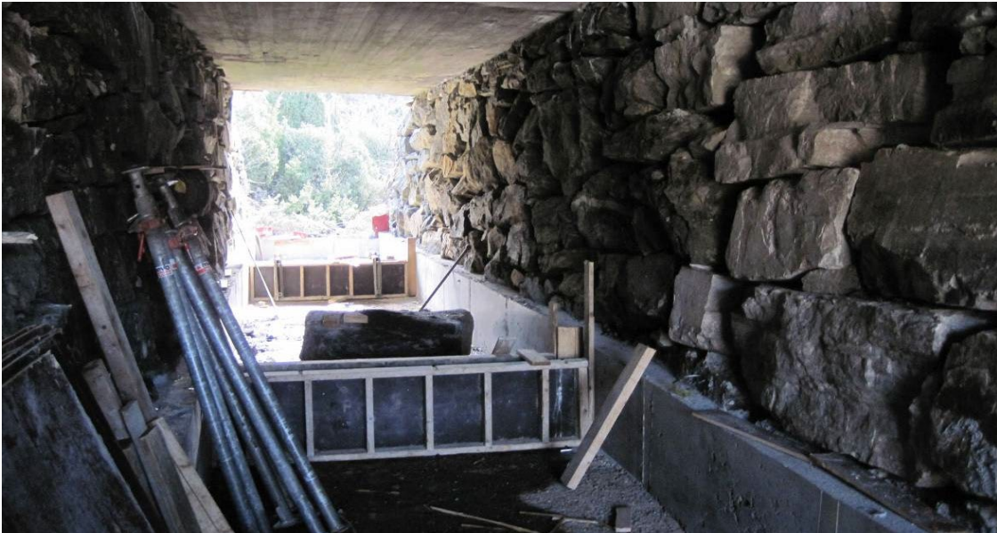
Figur 56. Bildet fra bygging av ny veikulvert ved en bekk i Sotra, Hordaland våren 2010. Her støpes det tverrvegger for å lette oppvandringen for fisk.
