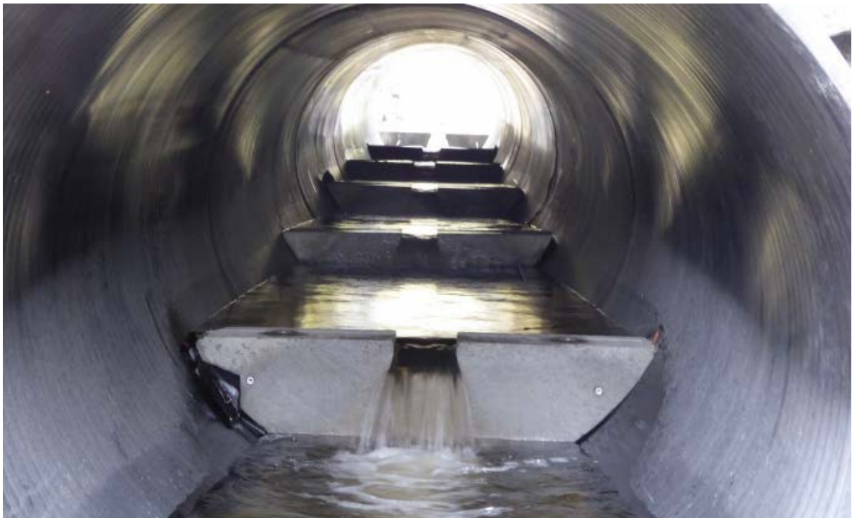
Figur 59. Støpte terskler i en veikulvert ((Pulg m.fl., 2018), Foto: Anton Rikstad)
