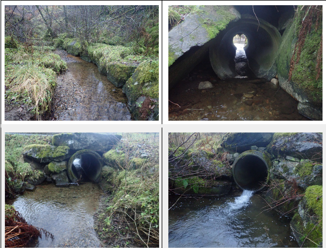
Figur 65. Eksempelbilder av inngrep i Litersbekken. Øverst: Kort parti med erosjonssikret elvebredd (venstre). Røret under traktorveien i øvre halvdel av bekken (høyre). Nederst: Nederste røret under Vassendvegen sett nedstrøms- (høyre) og oppstrøms (venstre).
