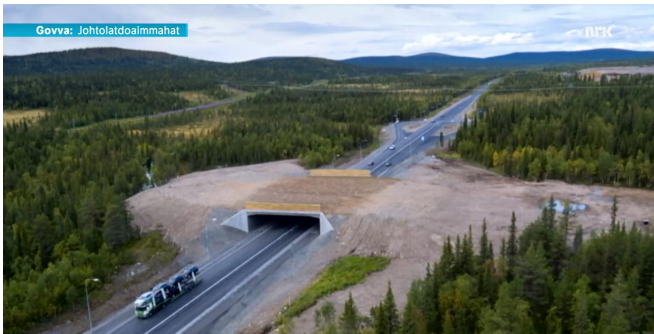
Figur 30.. «Økodukt» (ekodukt) over E10, Mertainen, Kiruna, Gabna Sameby, Sverige. (SVT 2016) Publisert 8.9.2016 https://www.svtplay.se/klipp/10228629/ekodukten-klar-att-anvandas
