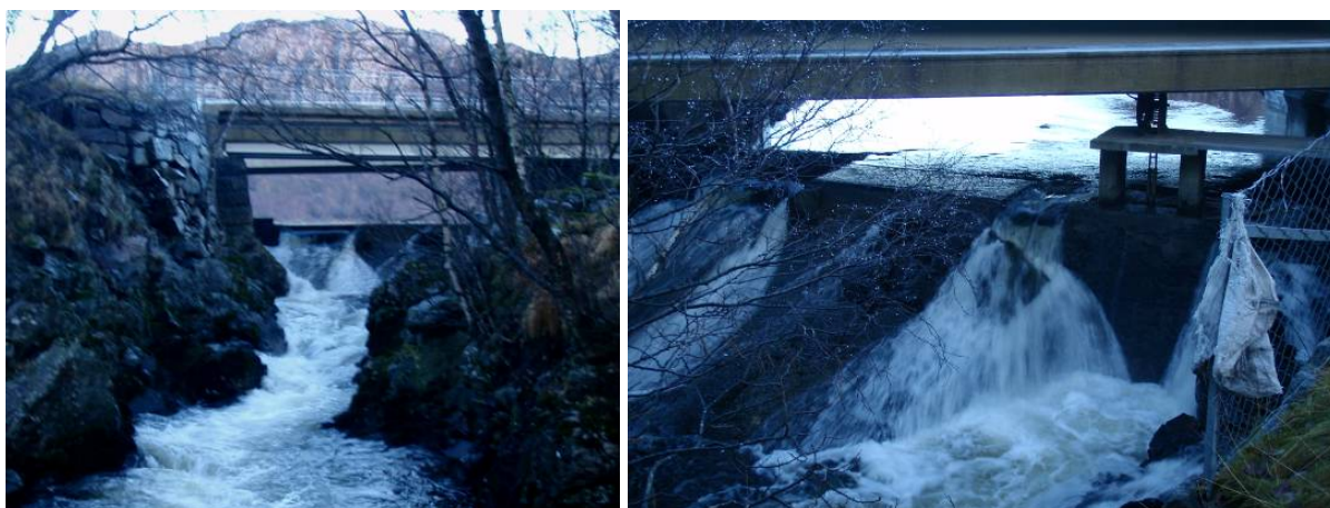
Foto: Demningen ved utløpet av Klugevatn tar lite hensyn til ålevandring slik den framstår i dag, og det er usikkert om arten kan passere installasjonen.
