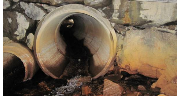
Figur 213 Kulvert nederst i vassdraget. Ved lav vannstand virker den som vandringshinder.
