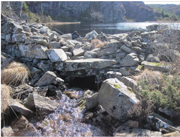
Figur 313 Utløpet av Hesttjørna var også tilstoppet med drivgods 21.04. 2010 slik at fisk ikke kunne vandre opp.
