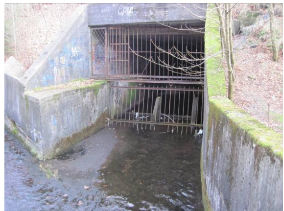
Figur 69 Kulvert til Ortuvannet
