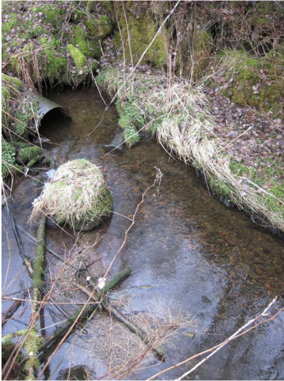
Figur 61 Gyteareal ved utløp av rør fra bekkelukking
