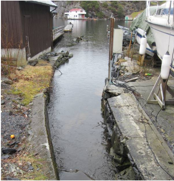
Figur 186 Munning i Juvika er kanalisert og steinsatt.
