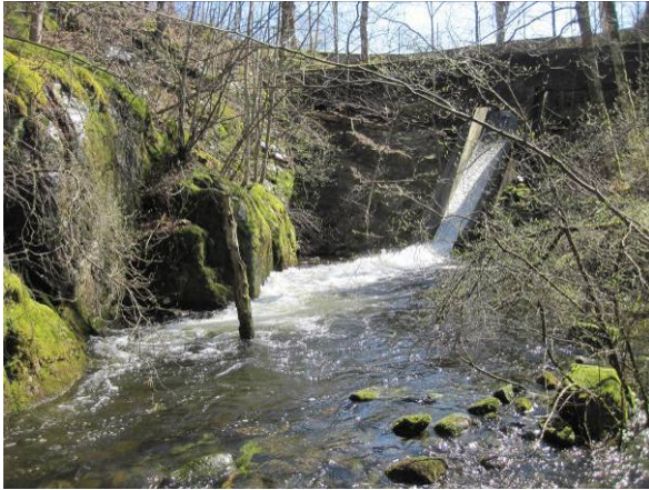
Figur 94 Demningen ved Gravdalsvatnet virker som et vandringshinder
