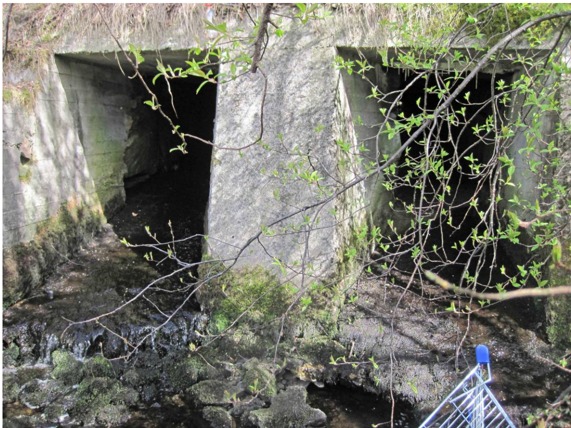
Figur 48 Kulvert gjennom Osbanedammen mellom Apeltun- og Iglavannet. Kulverten vurderes som permanent vandringshinder.
