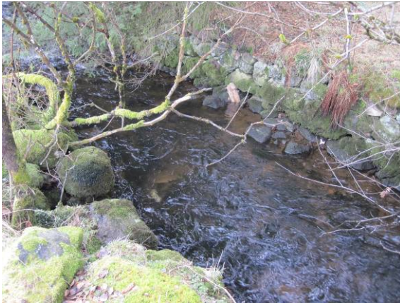
Figur 66 Anadrom del av Sælenelven med erosjonssikring langs elvebredden som delvis er rast sammen.
