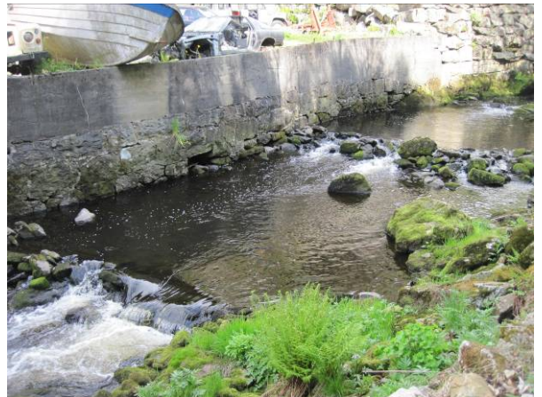
Figur 81 De nederste 60 m er kanalisert, breddene er erosjonssikret med betongvegger (nord), steinsetting og steinmur (sør).
