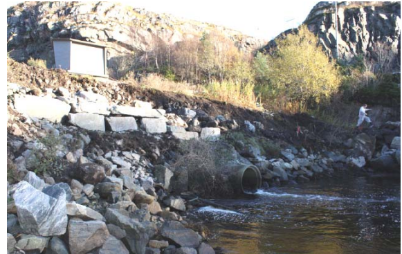
Figur 275 Dagens munning i Apalvågen gjennom to rør (Foto. Vindenes)
