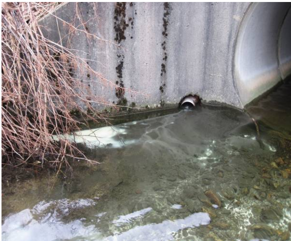
Figur 134 Utslipp av spillvann ved øvre kulvert i dagens anadrom strekning
