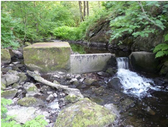
Figur 39 Vanninntaket som virket som et vandringshinder avhengig av vannføringen, ca 300 m ovenfor munning.
