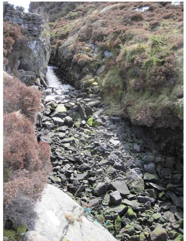
Figur 300 Elven siger gjennom en fylling helt nederst i vassdraget som virker som vandringshinder. Bare ved flom er det en mulighet for fisk å komme opp eller ned.
