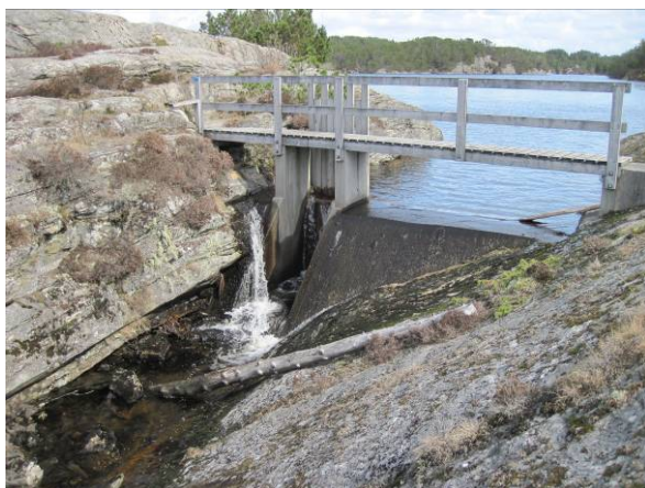
Figur 291 En demning hindrer oppgang av fisk etter ca. 50 m.
