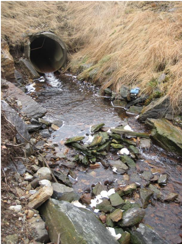
Figur 228 Kulvert i sidebekk sør for Merkestjøna virker som vandringshinder i store deler av året.
