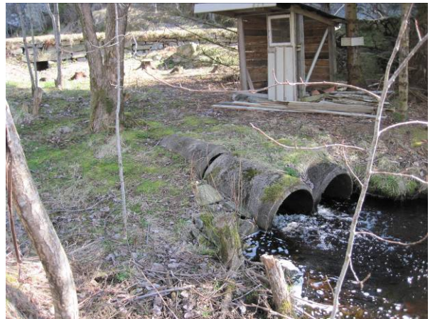
Figur 304 Kulvert mellom Alheim- og Dalsvatnet. Kulverten vurderes som vandringshinder.
