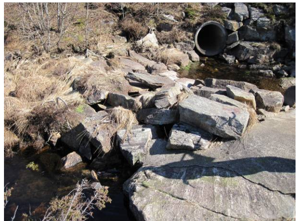
Figur 247 Kulvert under veien mot Kårtveit ligger for høyt og er et vandringshinder store deler av året. Terskel nedenfor hever vannspeilet ved flom men er ikke tett og vann siger gjennom ved middel og lav vannføring
