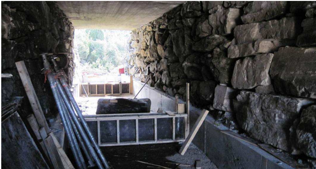
Figur 6. Bildet fra bygging av ny veikulvert ved en bekk i Sotra, Hordaland våren 2010. Her støpes det tverrvegger for å lette oppvandringen for fisk.
