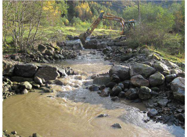
Figur 59 Fra restaurering 2012, tersklene ble senket for å øke vannhastighet og å bedre vandringsmuligheter.
