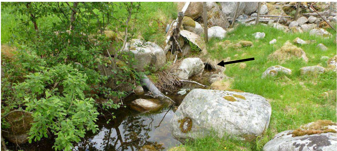
Figur 34 Tilløpet er delvis tilstoppet – men det virker ikke vanskelig å sørge for mer vann middels rydding av grøft og rør (pil).
