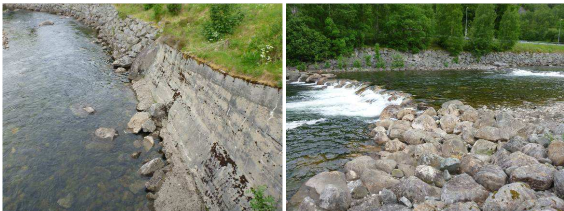
Figur 10 Forbygninger og kunstige terskler i nedenfor veibroen.
