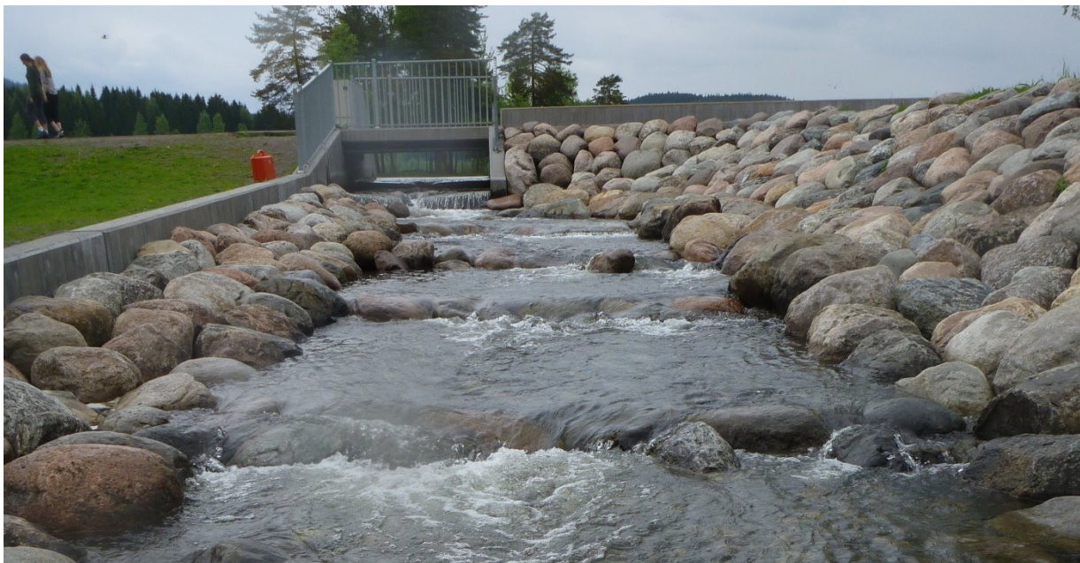
Fig. 32 Passerbar kulvert med terskeltrinn som hever vannspeilet nedenfor, ved Songsvann i Oslo. En rampe av små terskeltrinn på 10-15 cm og lavvannsrenne i midten gjør vassdraget passerbart for fisk. Samtidig ivaretas tekniske og hydrauliske rammer, som stabilisering av vannstand og flomavledning. Tiltaket ligger i flomløp og er dimensjonert deretter. (VAV Oslo kommune med Norconsult og Uni Research Miljø LFI).
