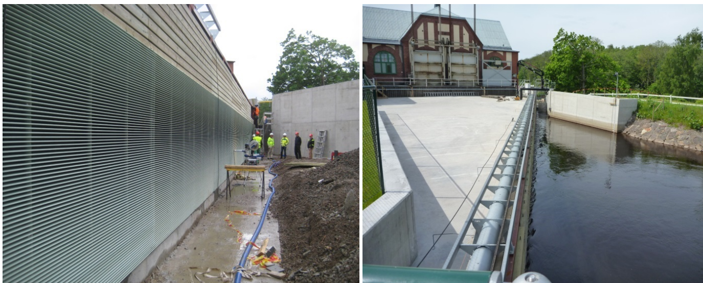
Fig. 141 \beta -varegrind med fluktåpning (bakgrunn) uten og med vann. Varegrinden har horisontale spiler med 15 mm spaltevidde, automatisk ristrensning og vertikal fluktåpning som også brukes som spyleluka (Foto: Olle Calles).
