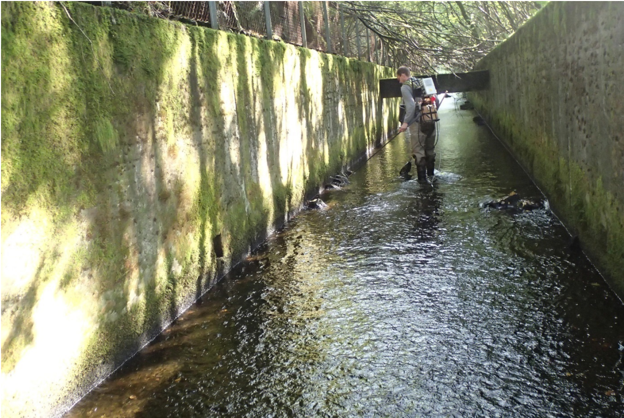
Fig. 62 Det er lite fisk på elvestrekninger som har blitt erosjonssikret med plastring eller betong fra alle kanter. Slike lokaliteter mangler skjul, variasjon, gytegrus og tilgang til hulrom i elvebunnen. Strømhastigheten er stor ved flom, og tilførselen av gytegrus og rullestein fra elvebredden er blokkert.
