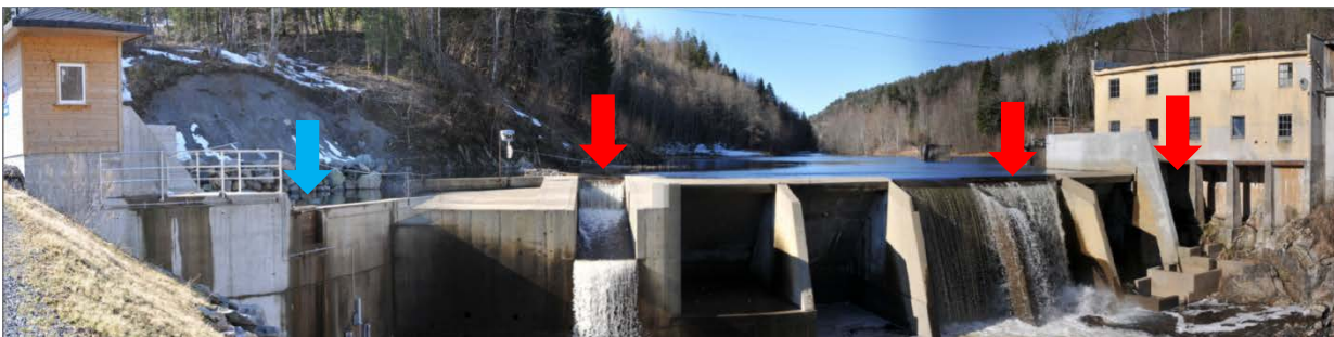
Fig. 106 Fosstveit kraftverk sett oppstrøms (over) og nedstrøms (ned) damkronen. Fluktåpningene som ikke fungerte er markert med rød pil, mens det velfungerende er markert med blå pil. Det brukes vannavskiller og rør for å lede fisken frem til elva igjen etter at den har vandret gjennom fluktåpningen (vises ikke på bilde).
