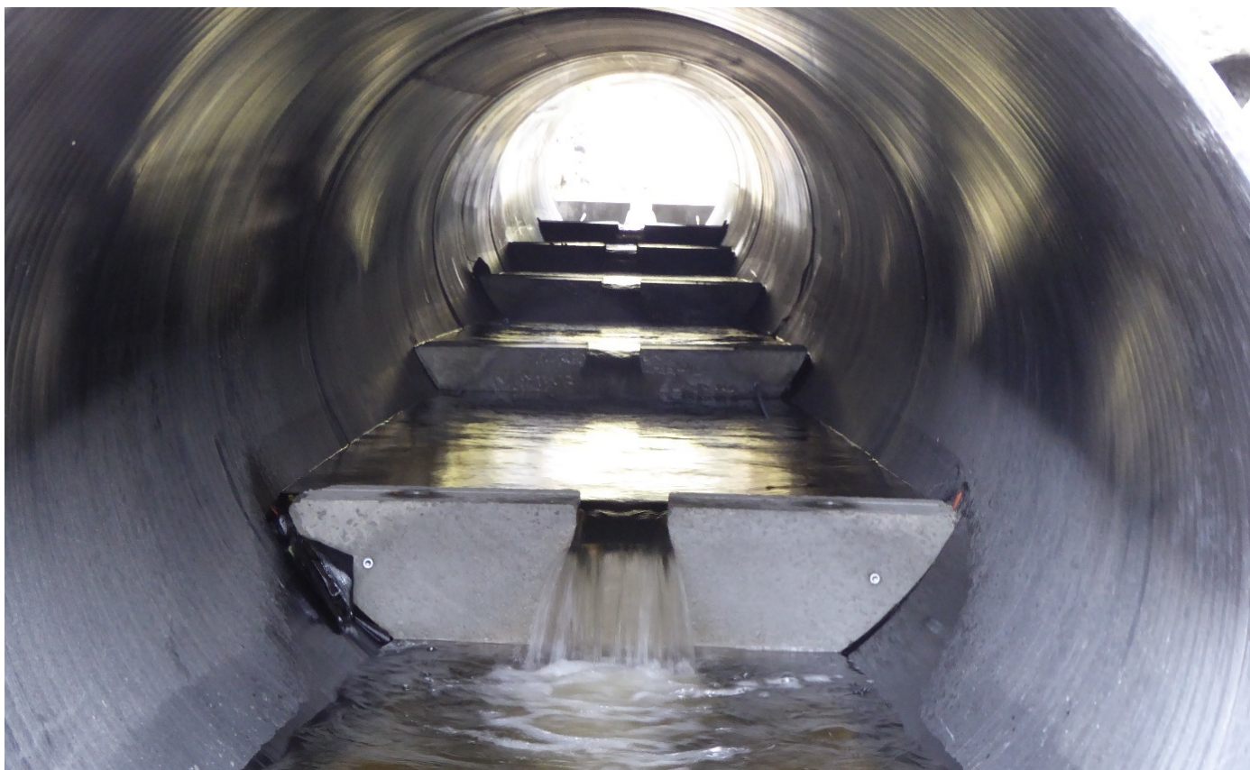
Fig. 30 Støpte terskler i en veikulvert. Vandringsforholdene kan bedres ytterligere med spalteformete utsparinger i tersklene. Bredde i utsparing bør ligge mellom 20 og 60 cm, avhengig av forventet vannføring. Foto: Anton Rikstad
