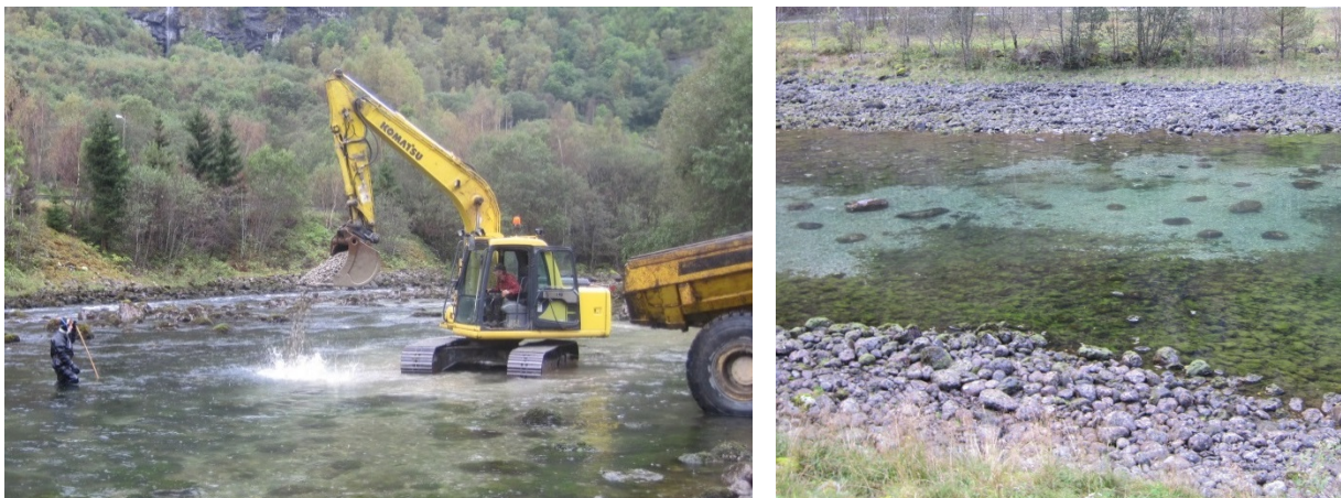
Fig. 50 Grusutlegg i Aurlandselven, 2013. En fiskebiolog følger med under og over vann, og anviser maskinfører. Ferdig gyteplass på bildet til høyre.
