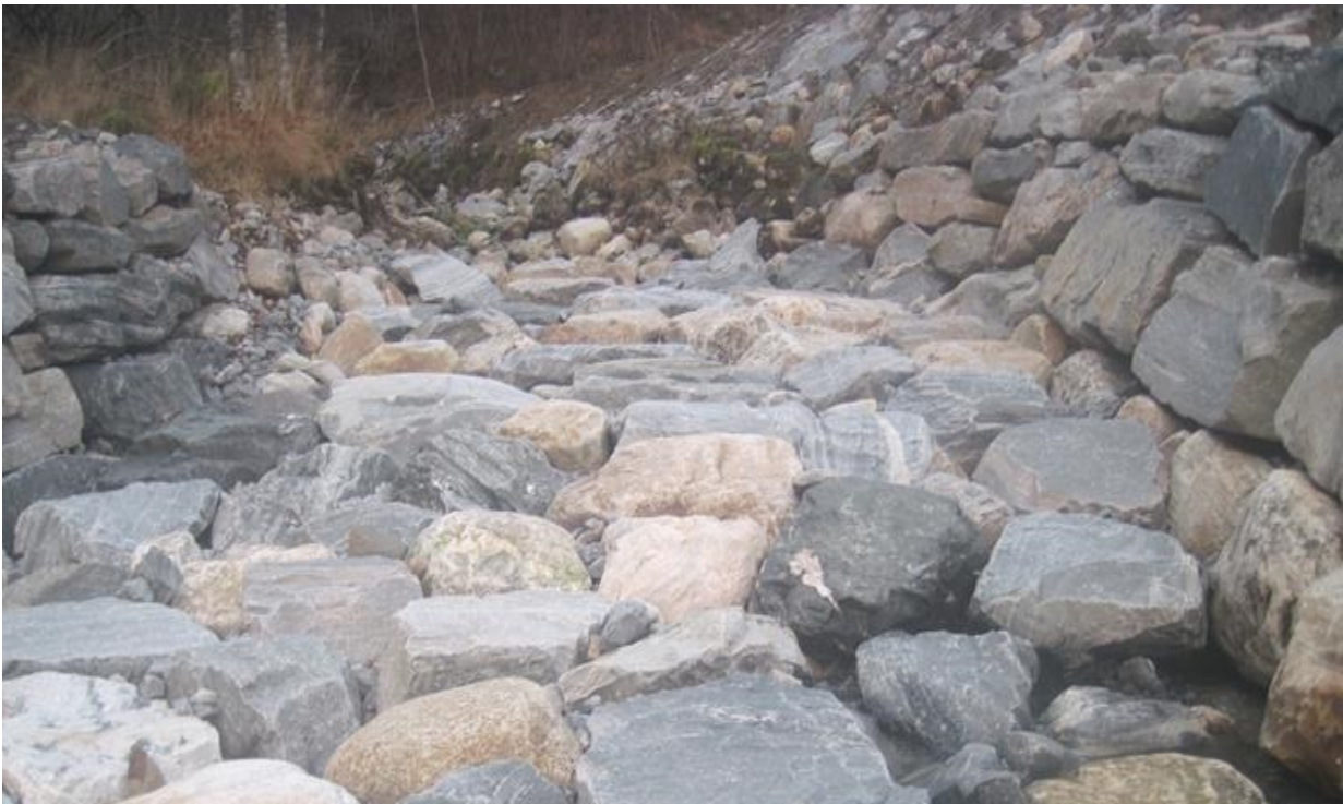
Fig. 10 Kanalisering og erosjonssikring ved plastring av både elvekanter og elvebunn kan fjerne fiskehabitat fullstendig. Det kan dessuten redusere vandringsmuligheter for fisk, som vist på dette bildet fra en anadrom bekk ved Nordrevik, Høyanger kommune i Sogn og Fjordane. Vannet sildrer gjennom plastringen. Bekken ble erosjonssikret og kanalisert i 2012. Lignende miljøreduserende tiltak er fortsatt utbredt i Norge (Foto: Sven-Erik Gabrielsen). Sammenlign med alternativ utforming på side 113, Fig. 66.
