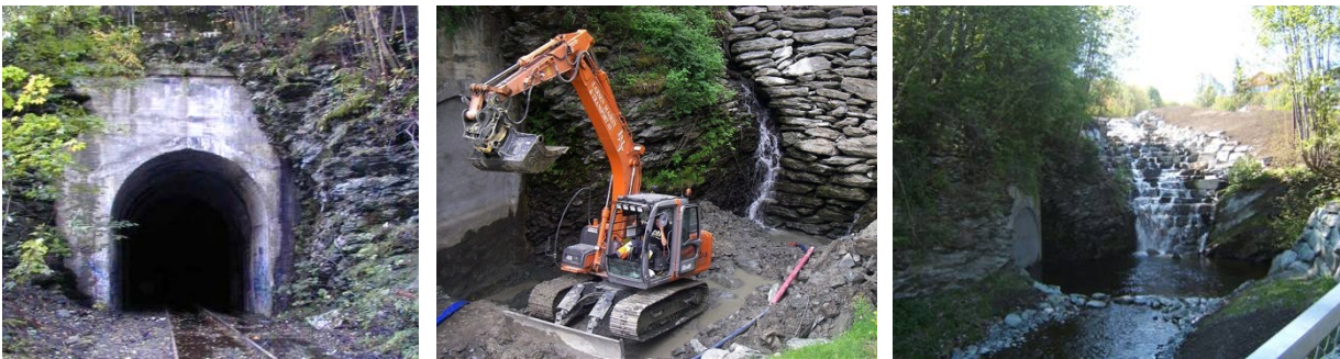
Fig. 111 Gammelt jernbanespor ble i 2005-2006 omgjort til kulp og foss. Foto: Trondheim kommune.
