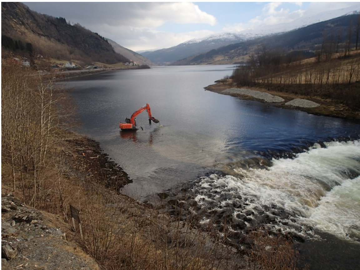
Gravemaskin ble benyttet for å legge ut grusen i mars 2014. På motsatt elvebredd ligger hauger med siktet grus klar for utlegging.
