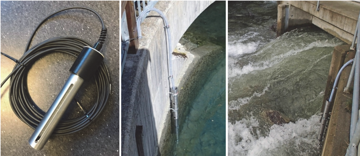
Fig. 35 Varighetsvervåking av gassovermetning i elver er mulig med robuste saturometer. Målestedet må sikre nok vannstrøm og vandyp og monteringen må tåle flommer, sedimenttransport og is.
