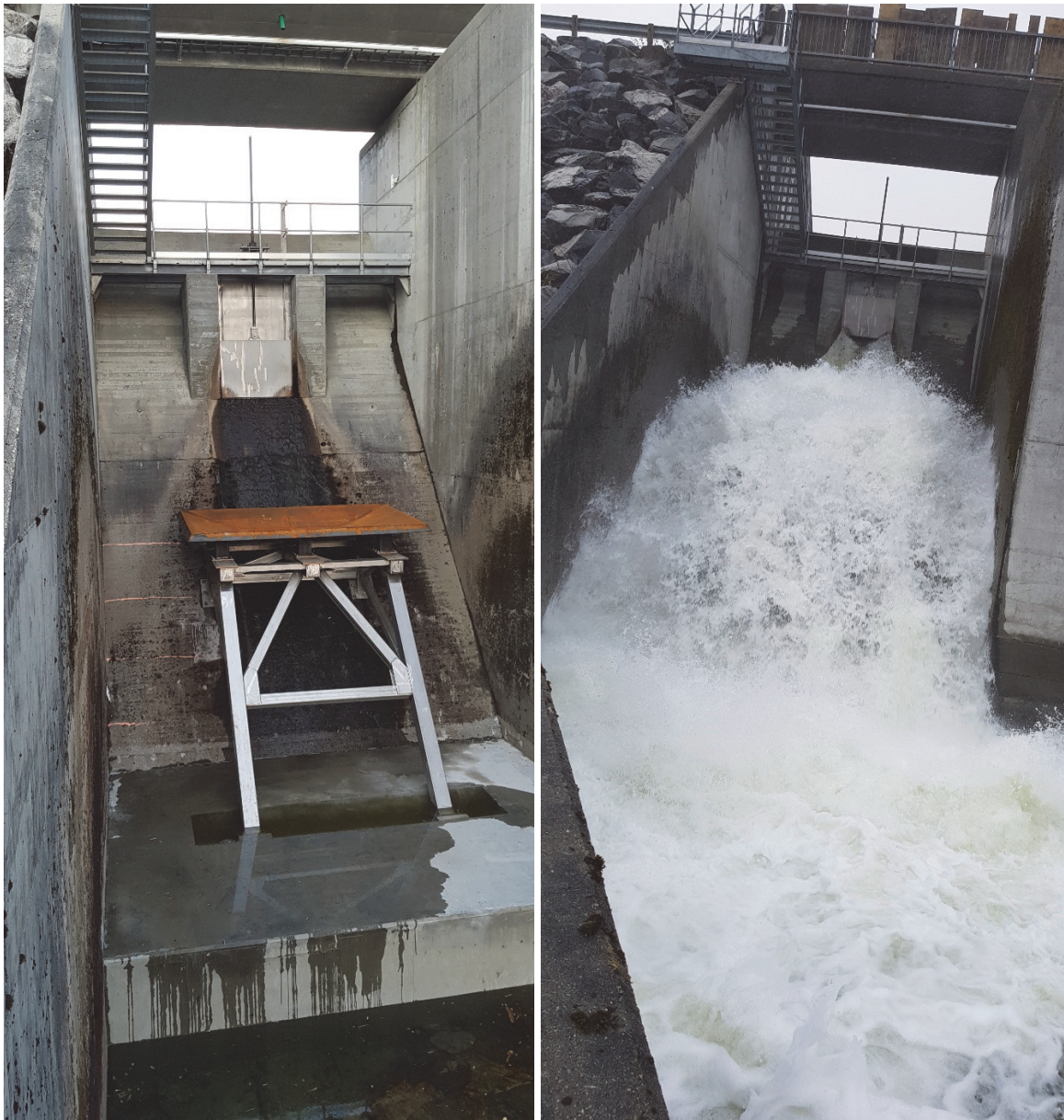
Fig. 41 Deflektoren etter installasjon i dam Tjurmoen 2018, med og uten vann. Første testkjøring indikerer en reduksjon av gassovermetning med 63-75 %. (Foto S. Stranzl)
