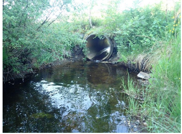
Figur 37. Kulvertene var ok men det bør lages strukturer inne i de.
