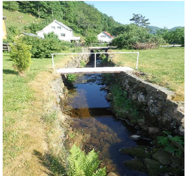
Bekken er senket og flomsikret enkelte steder.
