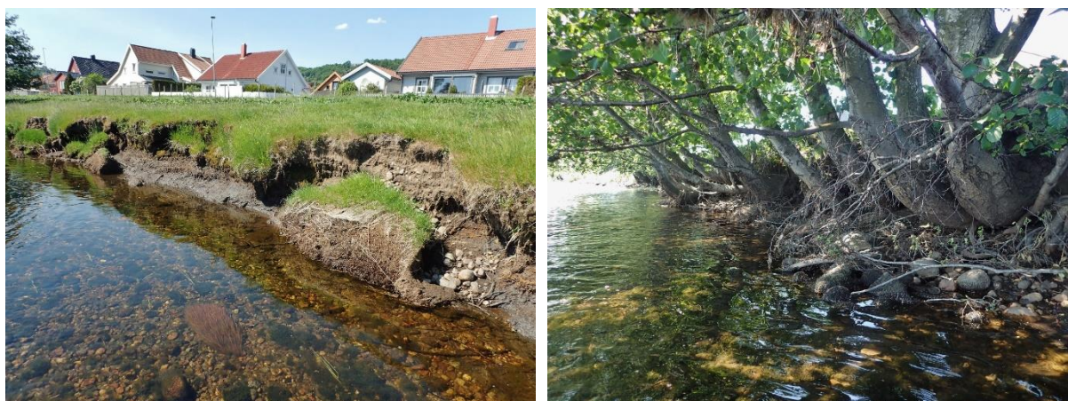
Figur 62. Eksempel på erosjon av elvebredd i Sokno som resultere i tilførsel av jord ved flom (t.v.). Like nedstrøms vokser kantvegetasjon som bidrar til naturlig erosjonssikring, samtidig som kantvegetasjon gir skygge og skjul for fisk, og til å binde opp avrenning av næringsstoffer og finsediment.
