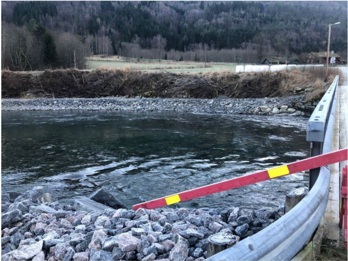
Figur 40: de tilførte masses ser ut som spengstein og det kan se ut som elvebunnen ble løftet betydelig, noe som kan ha redusert avløpstverrsnittet. Bilde tatt av Knut Stauri.
