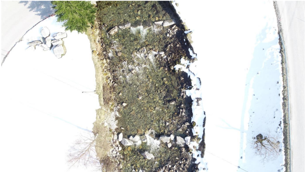
Figur 9. Nyetablerte terskler i Norddalselva ved Dalhus. Nedre med spalte grunnet at den ene steinen i midten har falt ut. Øvre terskel uten spalte. Noe grus på oppsiden av begge tersklene, men klart mest egnet gytehabitat på oppsiden av nederste terskel, trolig grunnet spalten. Etter at dette bildet ble tatt (våren 2021) er nedre terskel ytterligere ødelagt, men gyteområdet til venstre i bildet er fortsatt intakt.
