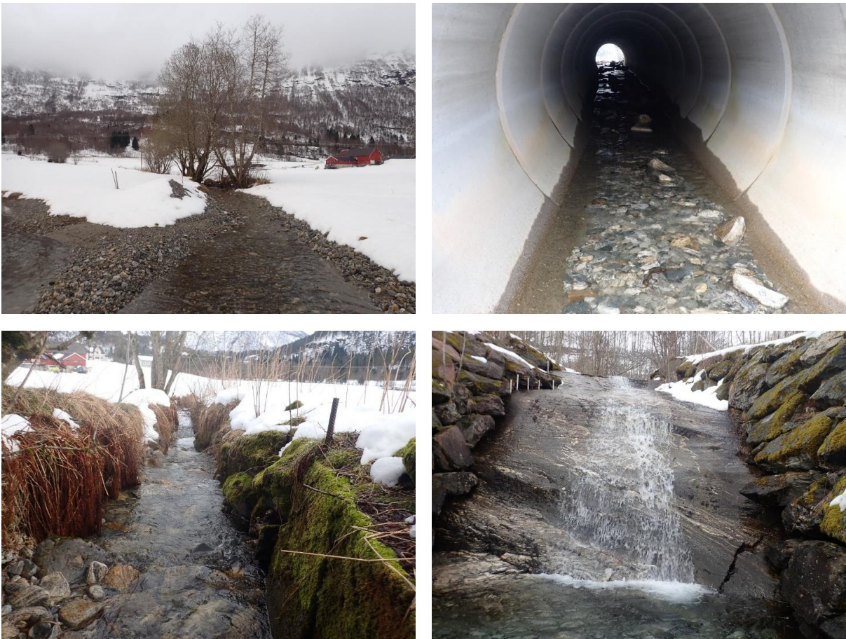
Figur 77. Nedre del av elva med manglende kantvegetasjon og mye grusdominerte gytearealer (oppe t.v.), øverste veikulvert med grus og stein som bunnsstrat (oppe t.h.), kanalisert elvestrekning med glissen kantvegetasjon (nede t.v.) og naturlig permanent vandringshinder rett ovenfor Kvivsvegen (nede t.h.).
