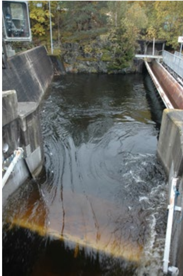
Figur 44. Isluka ved Kraftverksinntaket på Rygene.
