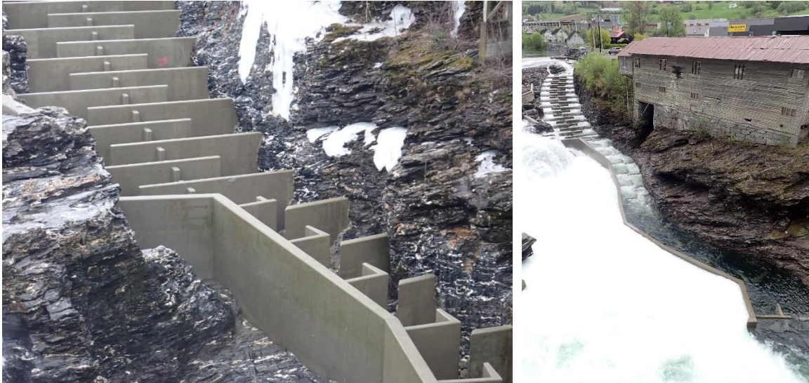
Spaltetrappen i Palmafossen. Bildet til venstre viser den doble passasjen i øvre del av bildet og overgang til vanlig spaltetrapp i nedre del. Bildet til høyre viser trappen ved en vannføring på 95 m 3 /s (Foto: NORCE LFI v/Ulrich Pulg).
