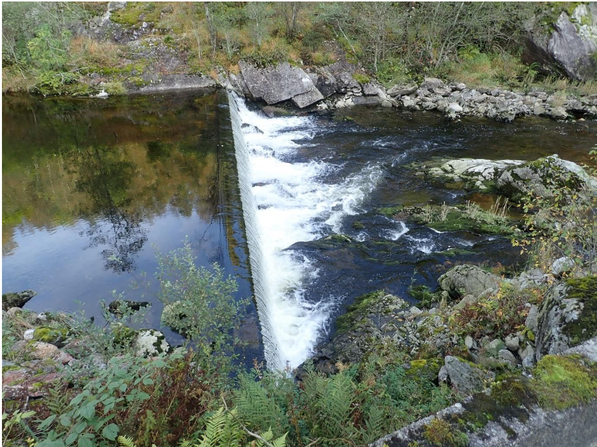
Figur 52. Betongterskelen på Langeland, hvor vannet renner rett ned på blokk og fjell.
