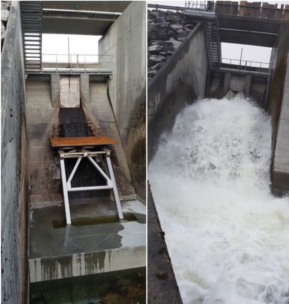
Deflektor montert i dam Tjurrmo i 2018 bidrar til å lufte ut overmettet vann som renner inn i på strekningen med minstevannføring som er et viktig habitat for bleka.
