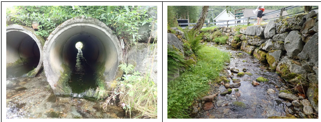
Det finnes fysiske inngrep i form av kulverter og plastring i Trondteigbekken.
