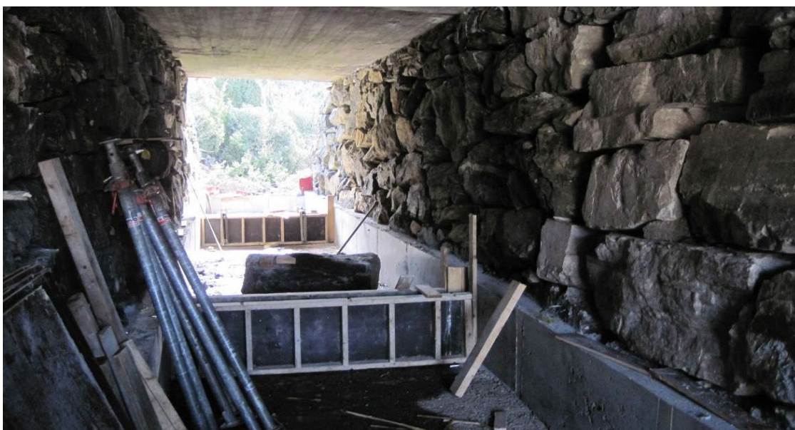
Figur 5. Bildet fra bygging av ny veikulvert ved en bekk i Sotra, Hordaland våren 2010. Her støpes det tverrvegger for å lette oppvandringen for fisk.
