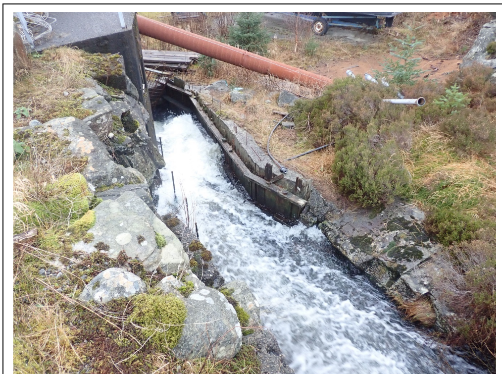
Kunstig vandringshinder nederst i elven mellom Øvre Halsvika og Steinsvatnet, samt nedre del av strykepartiet med slett betong i elvebunnen.
