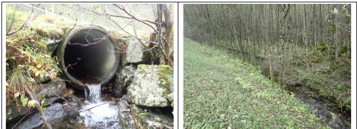
Figur 15. Hengende kulvert i sidebekk som munner ut i Svartehølen (t.v.). Lenger oppstrøms renner bekken langs E16 (t.h.).
