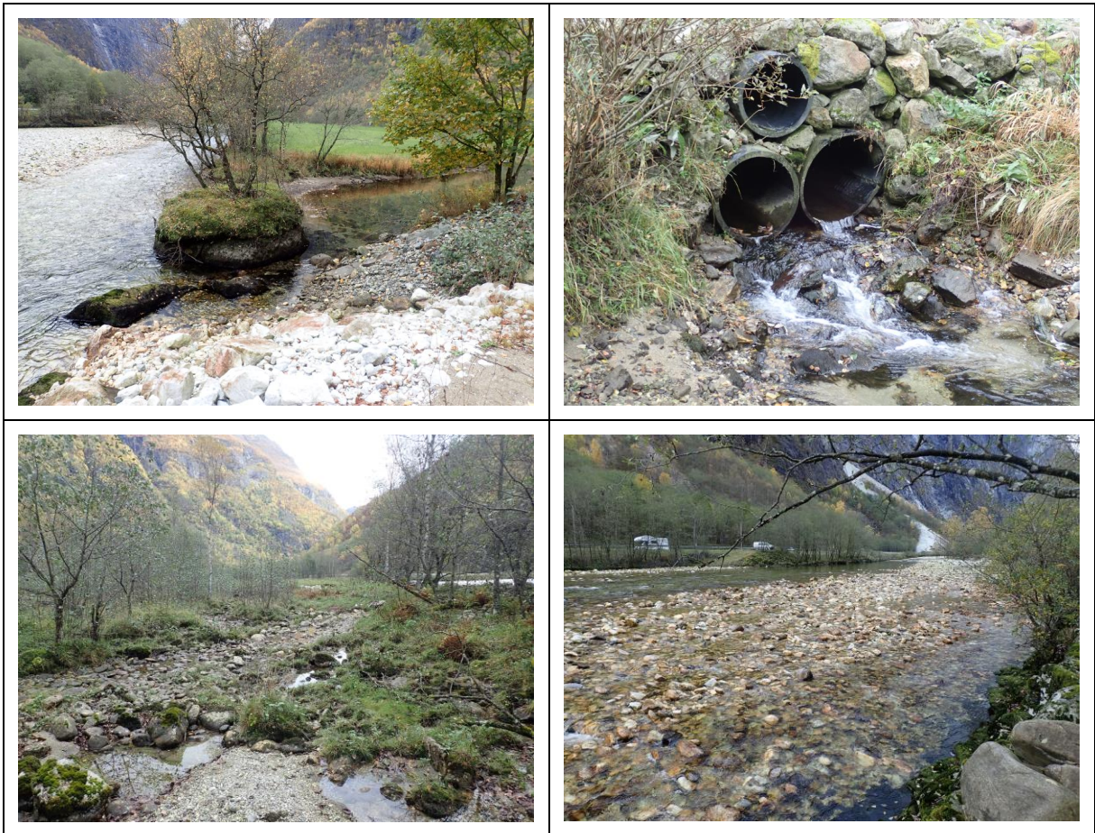
Figur 13. Utløp Hyllandsbekk (øverst t.v.); kulvert i Hyllandsbekk (øverst t.h.); vannsig under erosjonssikring og inn i Hyllandsbekk (nederst t.v.), bilde tatt fra erosjonssikringen mot hovedelva (nederst t.h.).
