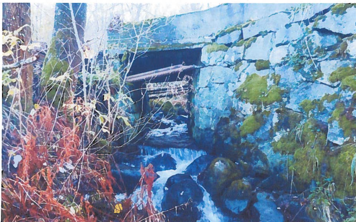
Figur 8. Veikrysning under Nedre Livei er vandringshindrende på lav vannføring.
