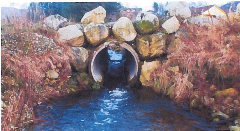
Figur 21. Vandringshindrende, men passerbar, betongkulvert (32 V 6526477 N, 317774 E) under vei anlagt ifbm masseuttak.
