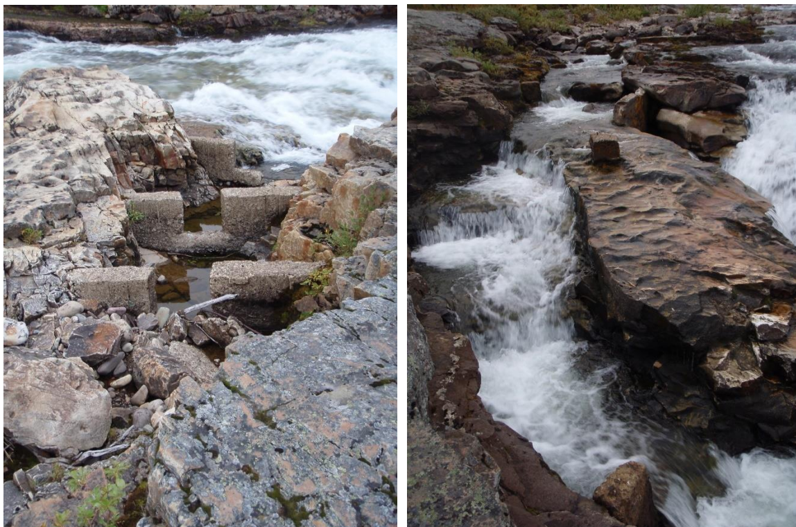
Fig. 49 Ødelagte trappeanlegg i Fjerdefossen
