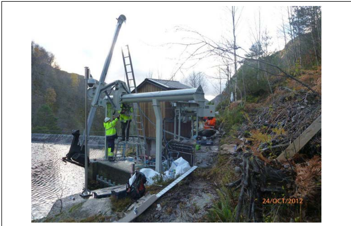
Figur 10. I oktober 2012 ble det installert en ristrensker i inntaket til Hommelfoss kraftstasjon. Foto: BKK Produksjon AS v/ Sissel Mykletun.
