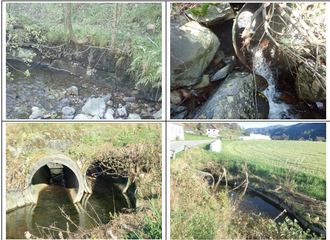
Figur 44. Eksempelbilder av fysiske inngrep i Mosbekken. Øverst: Erosjonssikret elvebrekke (venstre) og den øverste kulverten (høyre). Nederst: Nederste kulvert med sikring av ene elvebredden med betongblokker og fjernet kantvegetasjon.
