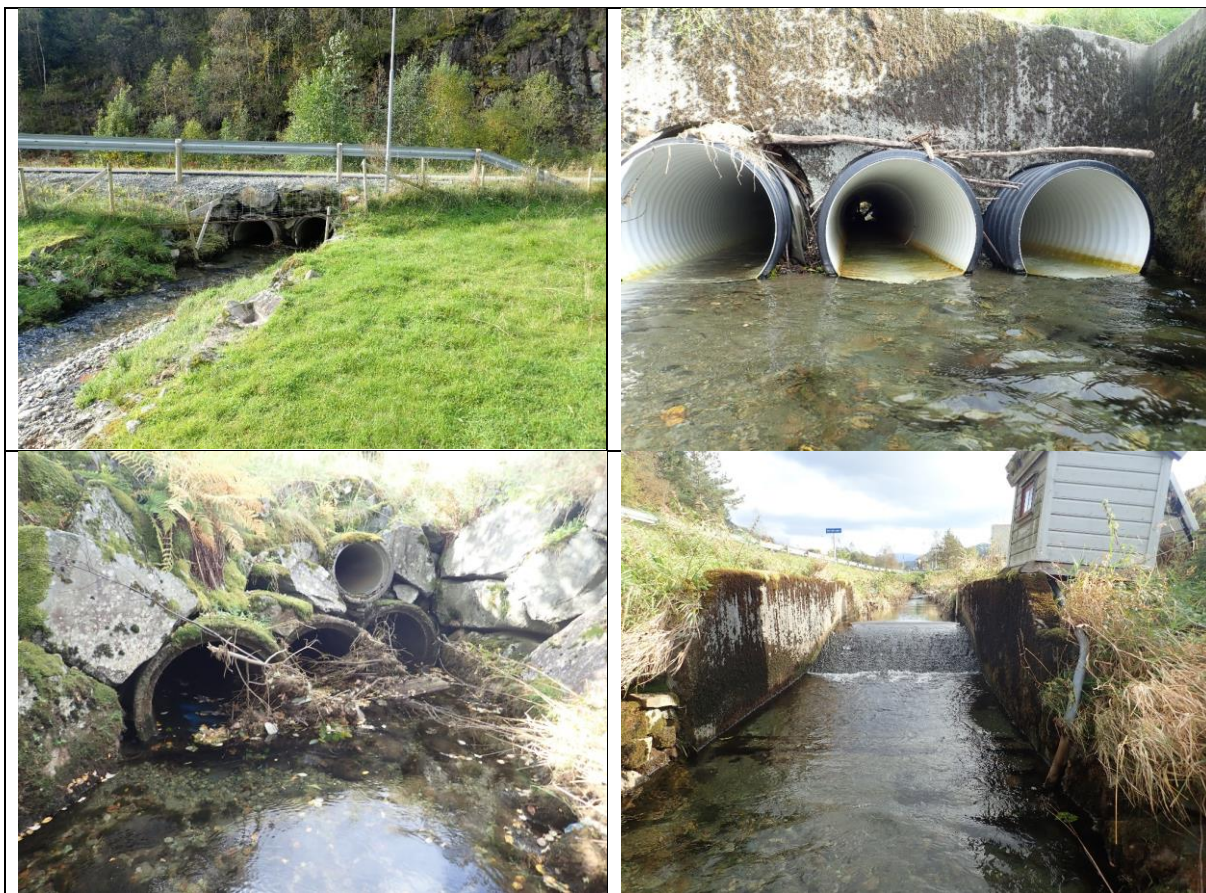
Figur 102. Eksempelbilder av inngrep og påvirkninger i Prestabekken. Øverst: Kulvert 1 (venstre) og kulvert 2 (høyre). Nederst: Kulvert 3 (venstre) og betongrampe i en strekning med erosjonssikring og fjernet kantvegetasjon (høyre).
