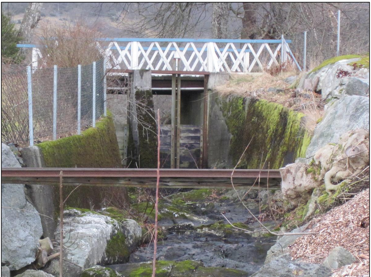
Figur 15: Sperre under bru ved midtre utløp fra Krossvatnet
