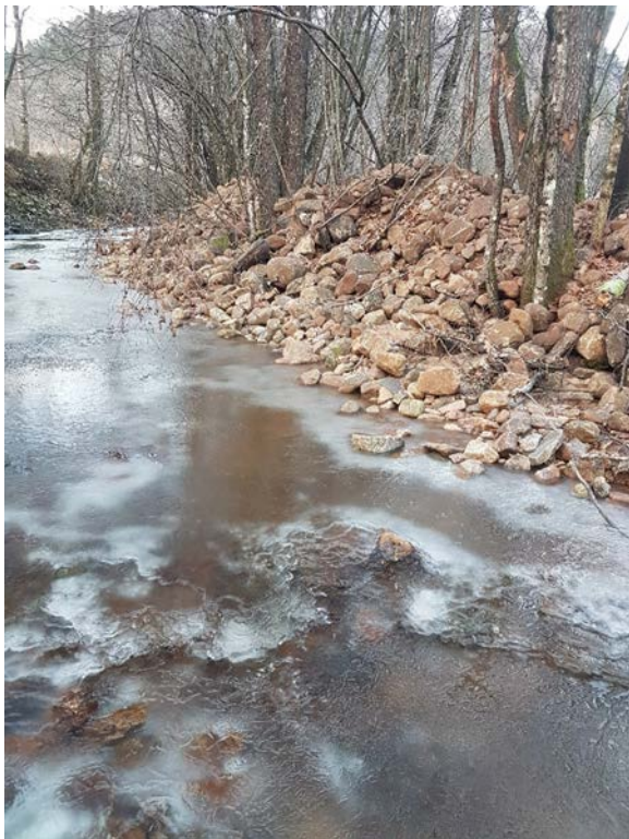
Et parti oppstrøms Øyan der elvemasse har blitt lagt opp langs elvekanten.
