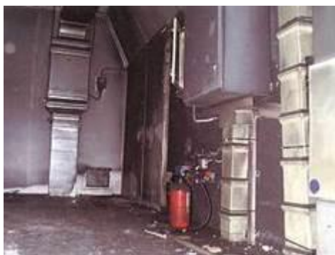
Figur 5.3: Tilfluktsrom #22 etter brannen
