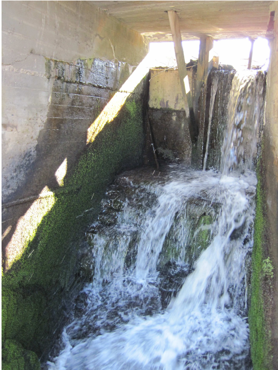
Figur 48 Luke i demning ved dammen på Flesland.
