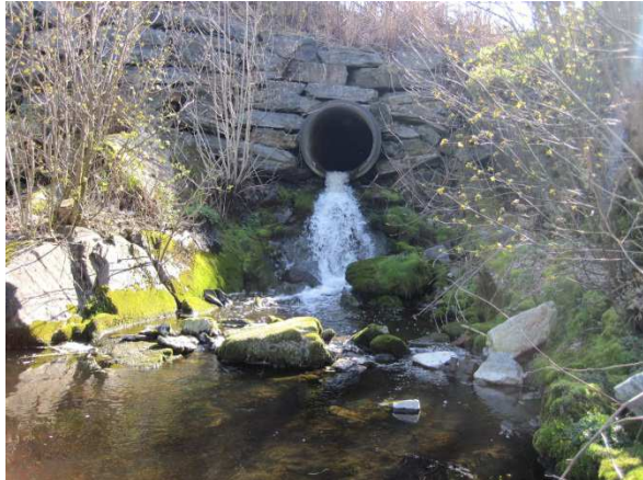
Figur 25 Kulvert under Fleslandsveien, en vandringsbarriere for sjøaure.
