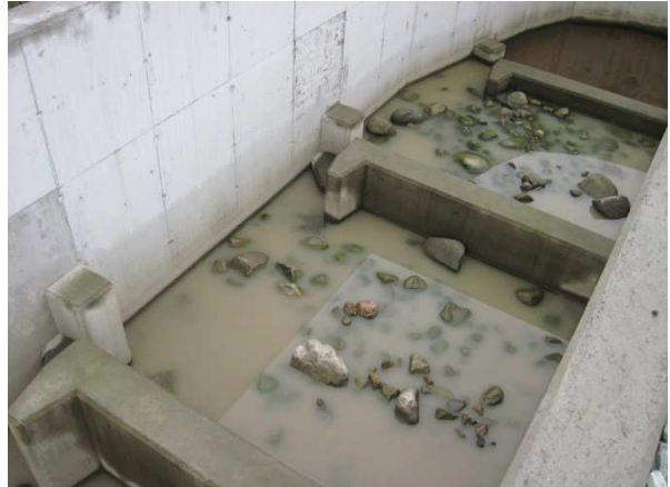
Figur 30 Detalj av fiskepassjen inn i kulvert under rullebanen: Trappetype er en blanding av Vertical slot pass og kulpetrapp for å imøtekomme både fiskenes vandringsadferd og perioder med svært lav vannføring.
