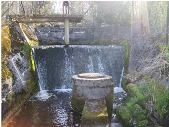
Figur 27 Utløp av kulvert (duknet) under rullebanen, vandringsbarriere for sjøaure.
