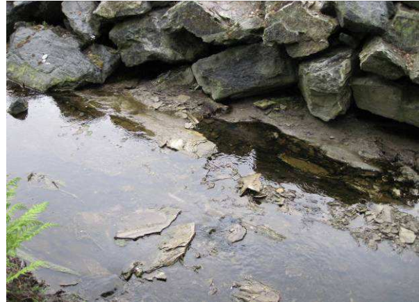
Figur 43 Elvebunnen er dekket med betongrester.
