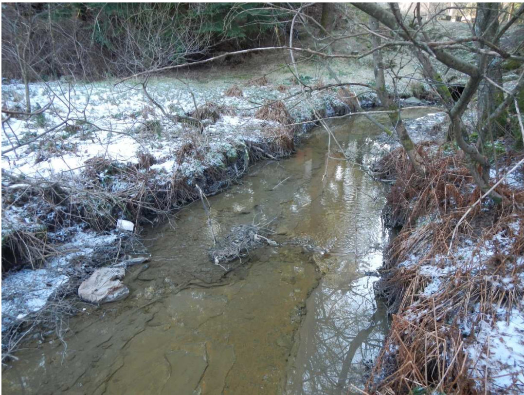
Figur 3 Lønningsbekken stasjon 2, ca 30 meter nedstrøms stasjon 1. Topplaget av sedimentene i bekken består av tette betongrester. Foto: G.Velle
