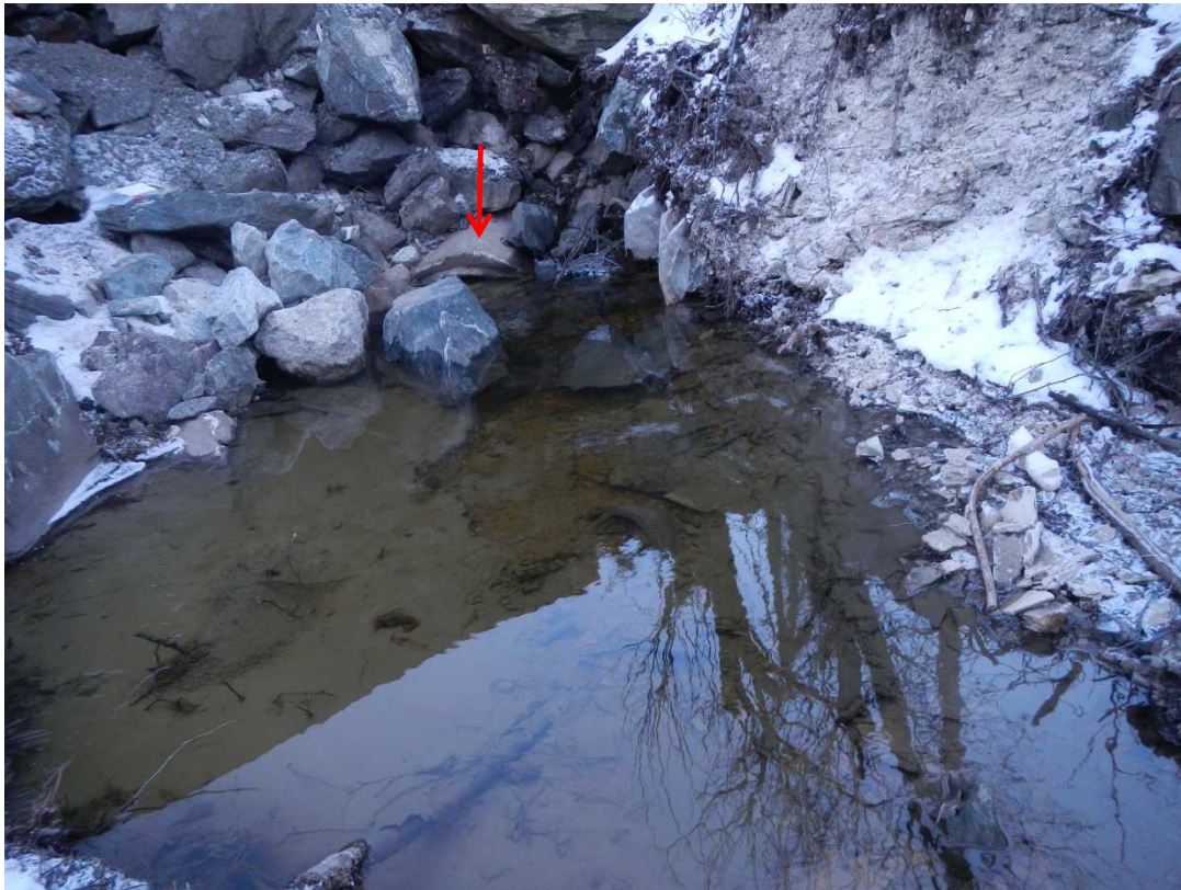
Figur 2 Lønningsbekken stasjon 1. Eksisterende kulvert under Fleslandsveien vises mot toppen av bildet (rød pil). Kulverten er delvis dekket og tettet av sedimenter og stein. Foto: G.Velle
