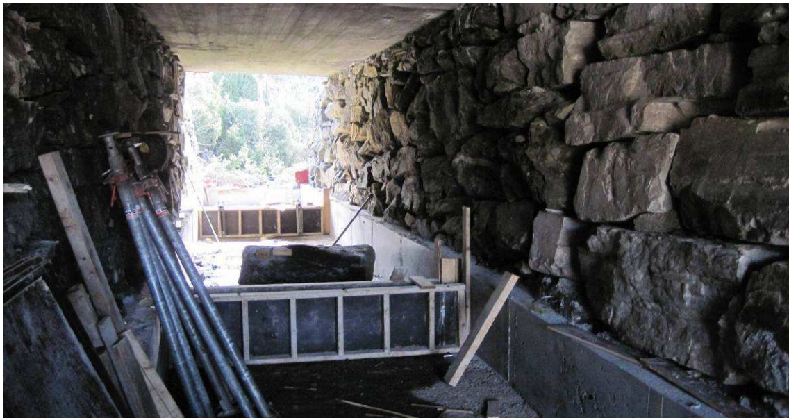
Figur 13 Bildet fra bygging av ny veikulvert (4/2010) ved en bekk i Årvika/Sotra. Her støpes det tverrvegger for å lette oppvandring av fisk.
