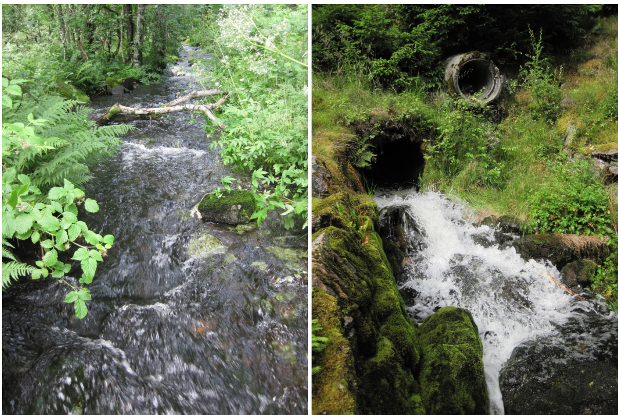
Figur 45 Nedre del av Leknebekken med produktive habitatbetingelser for sjøaure (til venstre). Til høyre veikulverten under E39 som virker som kunstig vandringsbarriere.
