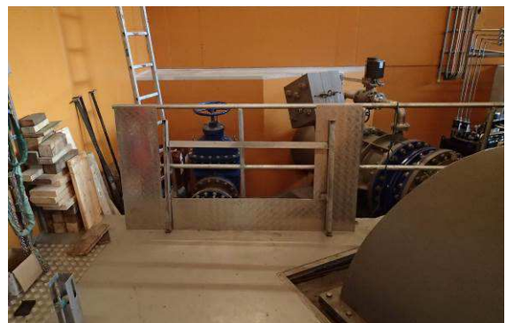
Figur 20 Omløpsventil (til venstre) og hovedventil (til høyre)
