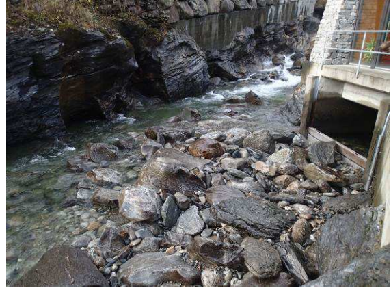
Figur 22 Klokken 10:34-11:05: Omløpsventilen leverer ikke lenger vann. Vannføringen nedenfor kraftverket stammer nå bare fra resttilsiget i gamle elveløpet opp mot inntaksdemning, deler av elvebunn blir tørrlagt.
