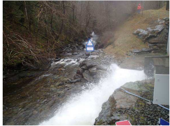
Figur 9 Klokken 12:54 – 13:09. Kraftutløp rett etter nødstop. Hovedventilen er stengt og omløpsventilen leverer vann.
