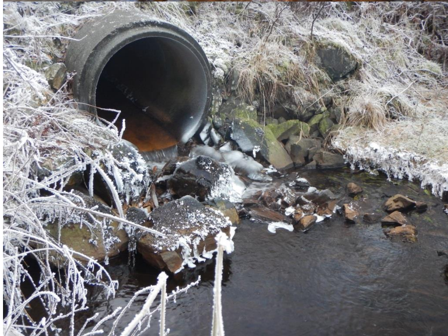
Fig. 13 Utløp av kulvert er et vandringshinder for fisk under lave vannstandsforhold
