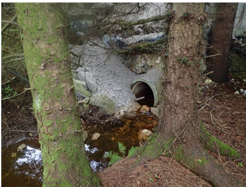
Figur 15. Like ovenfor Fleslandsveien oktober 2015. Kulvert i ferd med å tettes av sedimenter fra Betong Vest AS. Foto: U.Pulg.
