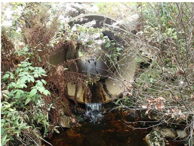
Kulvert er hengende og vanskeliggjør fiskevandring ved lav vannføring.
