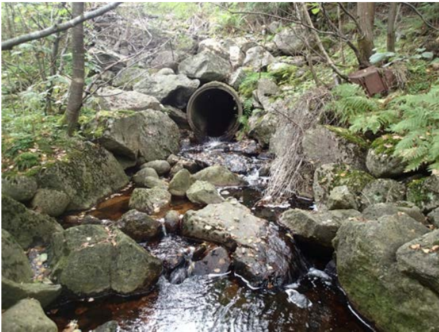
Utløpet med kulp-stryk variasjoner og gode skjulmuligheter. Kulverter er noe hengende men ikke vandringshinder. Det kan være aktuelt å danne en liten kulp for å heve vannspeilet inn i kulverten.
