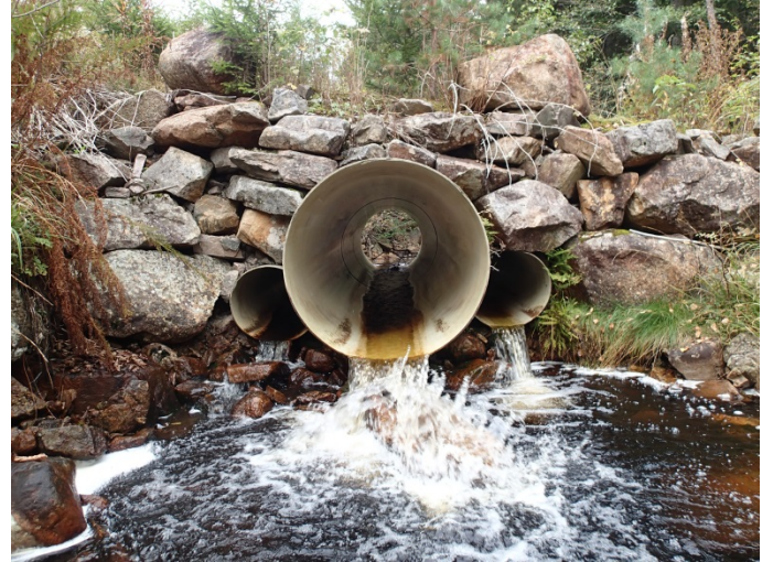
Hengende kulverter vanskeliggjør fiskevandring.
