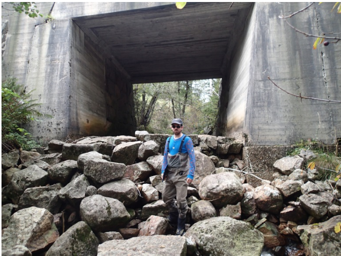
Krysningspunkt med hovedvei er vandringshinder. Bekken renner under kulverten i bratt ur.
