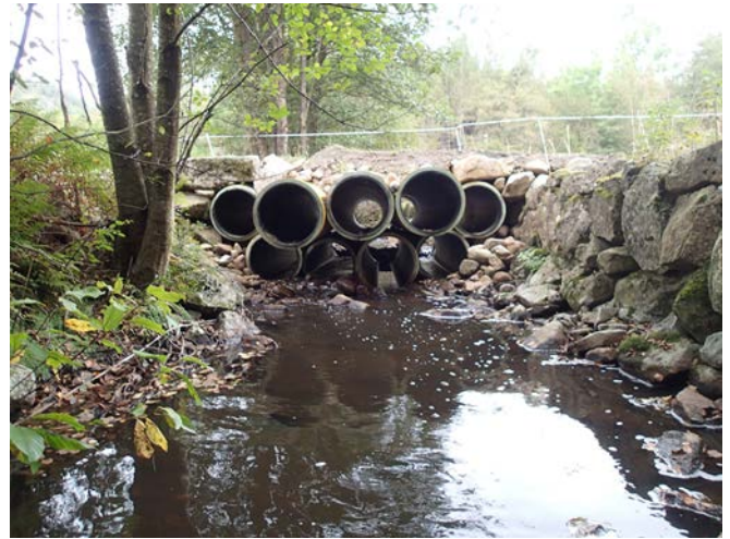
Kombinasjoner av flere kulverter sørger for god konnektivitet for fisk og reduserte flomskader.
