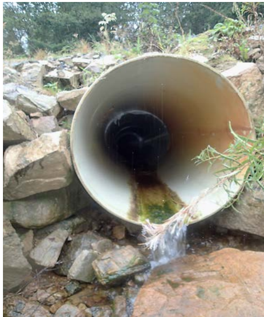
Hengende kulvert er vandringshinder.
