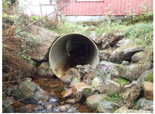
Kulvertene lå i flukt med elvebunnen og vandringsforholdene var gode. Flere steiner kan med fordel legges inn i kulvert.
