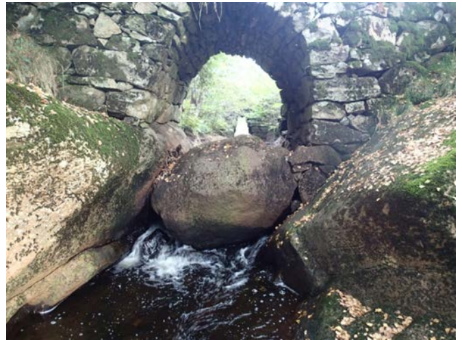
Stor blokk under den nederste brua fungerer som vannføringsavhengig vandringshinder. Det bør gjøres justeringer for å lette oppvandringen her.
