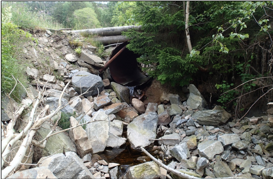
Bilde 14: "Hengende" kulvert (VP 290)
