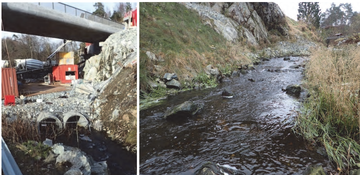
Fig. 12 Gjenåpning FØR-ETTER: Gjenåpnet strekning av Steinsvikbekken i Bergen med gyteplasser og produktivt ungfiskhabitat for sjørret. Ungfisktettheter av ørret og laks økte fra 6 individ/100 m 2 i og ved røret (2014), til 256 ind./100 m 2 (2016, Bybane Utbygging AS, Veidekke AS med Uni Miljø LFI).
