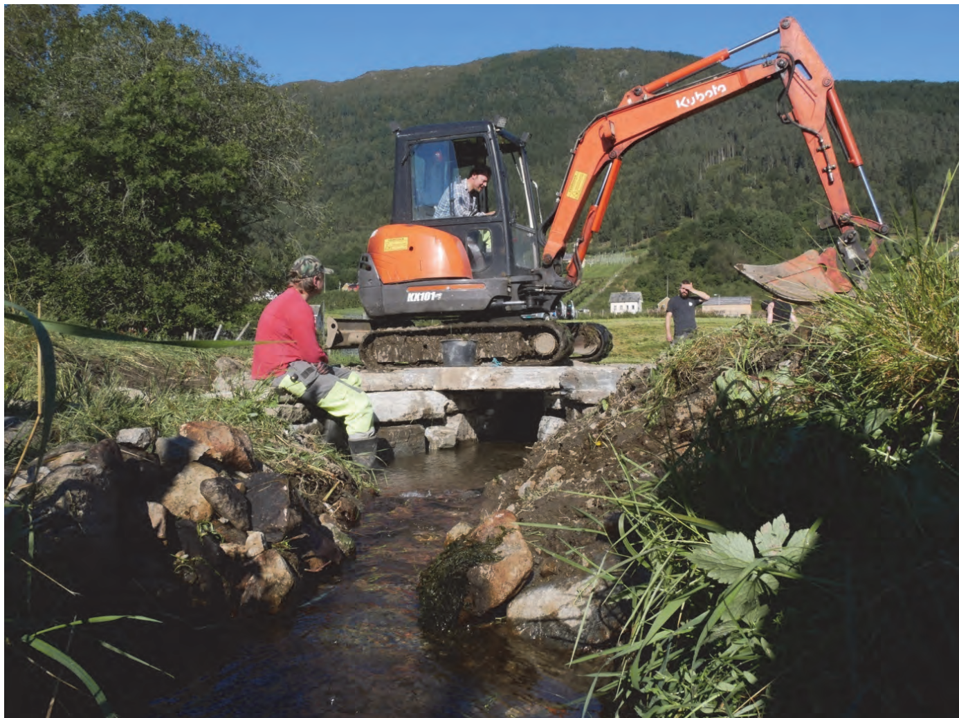
Ulvik Sportsfiskerlag har fjernet rørkulvert og bygget tradisjonell bro av steinheller med gjennomgående naturlig bunns substrat. Fisk kan vandre fritt igjen. (Foto: Hardangerfjord Villfisklag)
