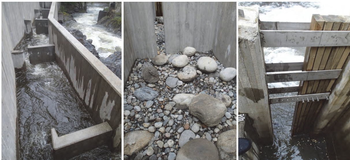
Fig. 37 Norges første spaltetrapp i Akerselva Oslo med typisk diagonalt strømningsmønster, gjennomgående bunnsstrat og nålestensel ved inntaket til finregulering av vannføring (Oslo kommune, Uni Research Miljø LFI, Norconsult, 2014).
