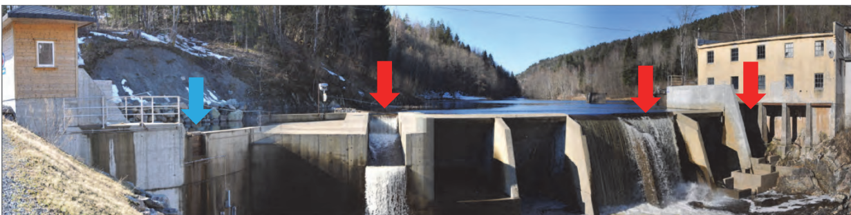
Fig. 106 Fosstveit kraftverk sett oppstrøms (over) og nedstrøms (ned) damkronen. Fluktåpningene som ikke fungerte er markert med rød pil, mens det velfungerende er markert med blå pil. Det brukes vannavskiller og rør for å lede fisken frem til elva igjen etter at den har vandret gjennom fluktåpningen (vises ikke på bilde).
