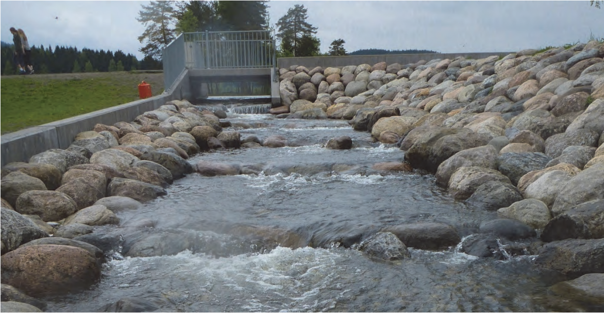
Fig. 32 Passerbar kulvert med terskeltrinn som hever vannspeilet nedenfor, ved Songsvann i Oslo. En rampe av små terskeltrinn på 10-15 cm og lavvannsrenne i midten gjør vassdraget passerbart for fisk. Samtidig ivaretas tekniske og hydrauliske rammer, som stabilisering av vannstand og flomavledning. Tiltaket ligger i flomløp og er dimensjonert deretter. (VAV Oslo kommune med Norconsult og Uni Research Miljø LFI).
