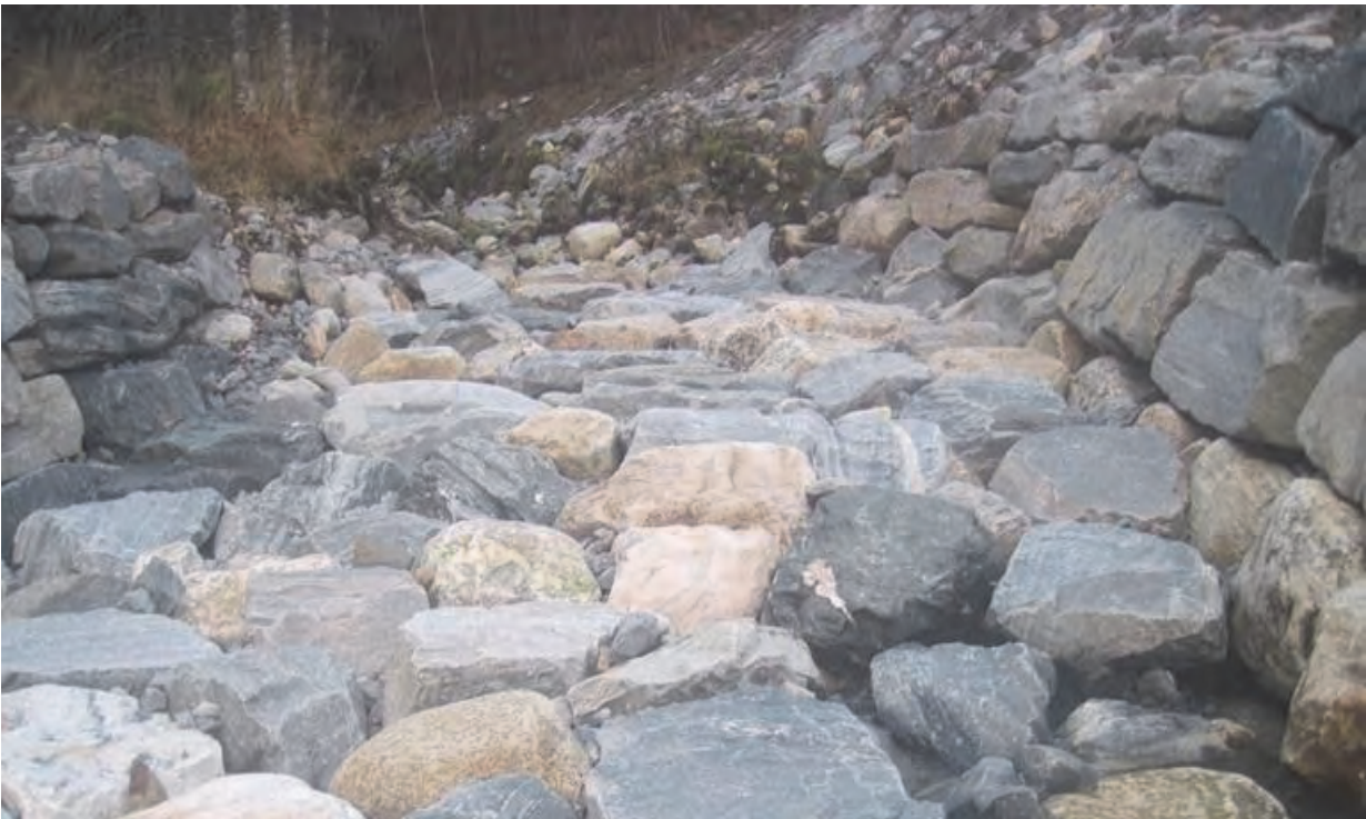
Fig. 10 Kanalisering og erosjonssikring ved plastring av både elvekanter og elvebunn kan fjerne fiskehabitat fullstendig. Det kan dessuten redusere vandringsmuligheter for fisk, som vist på dette bildet fra en anadrom bekk ved Nordrevik, Høyanger kommune i Sogn og Fjordane. Vannet sildrer gjennom plastringen. Bekken ble erosjonssikret og kanalisert i 2012. Lignende miljøreduserende tiltak er fortsatt utbredt i Norge (Foto: Sven-Erik Gabrielsen). Sammenlign med alternativ utforming på side 113, Fig. 66.
