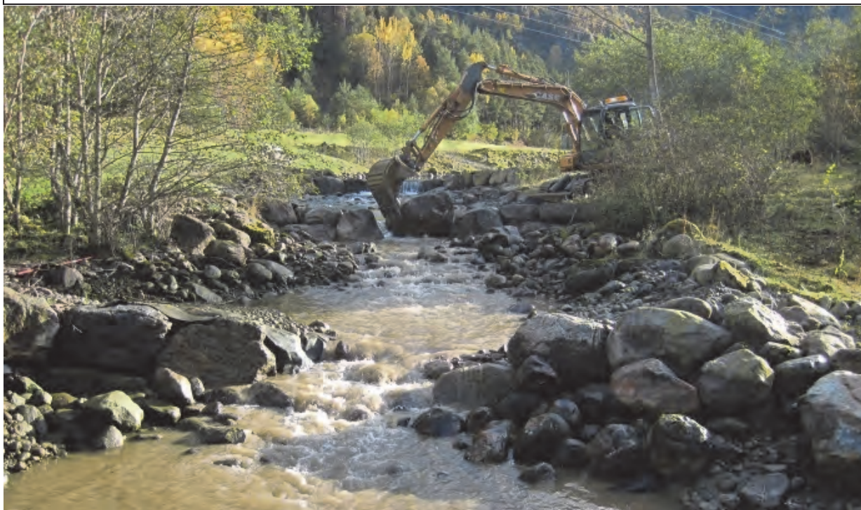
Fig. 16 Fjerning av terskler og reetablering av naturtypisk morfologi (trinn-kulp og stryk type) i sideløp til Aurlandselva (E-Co Energi, Melcon AS, Uni Research Miljø LFI, se også s. 127)
