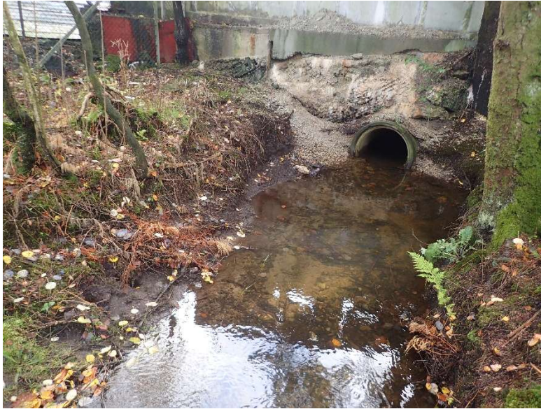
Figur 18. Lønningsbekken Like ovenfor Fleslandsveien oktober 2018. Det er ikke like mye betongrester som i 2015 og vannet er klarere på denne siden av veien enn på nedsiden av veien (Figur 17).
