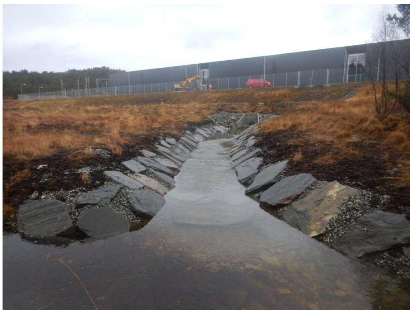
Figur 14. Plastret flomløp/dreneringskanal nedstrøms ny garasje for bybanen. Denne renner ut i Store Veitabekken (øvre del av Fleslandsvassdraget). Nedstrøms kanalen er grusen noe tett med finmasser.
