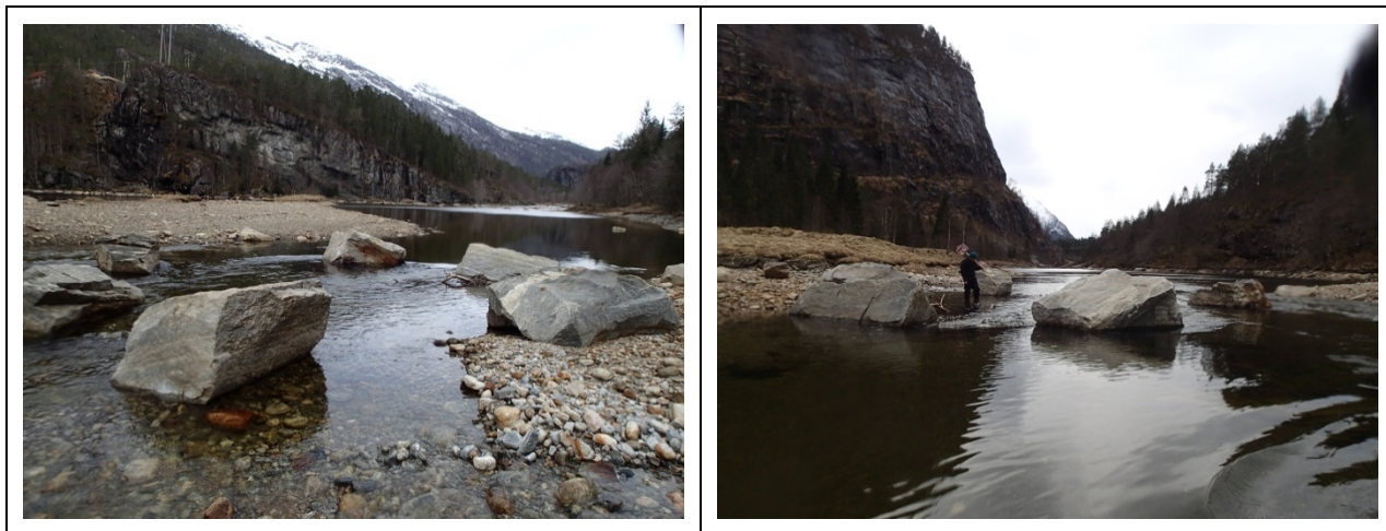
Figur 17. Midt i strekningen var det et smalere sund med egne forhold for gyting. Noen av de store blokkene ble flyttet for å bedre gytemulighetene på dette området.
